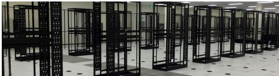
Figura 88: TPI2 - Racks de Amoblamiento
