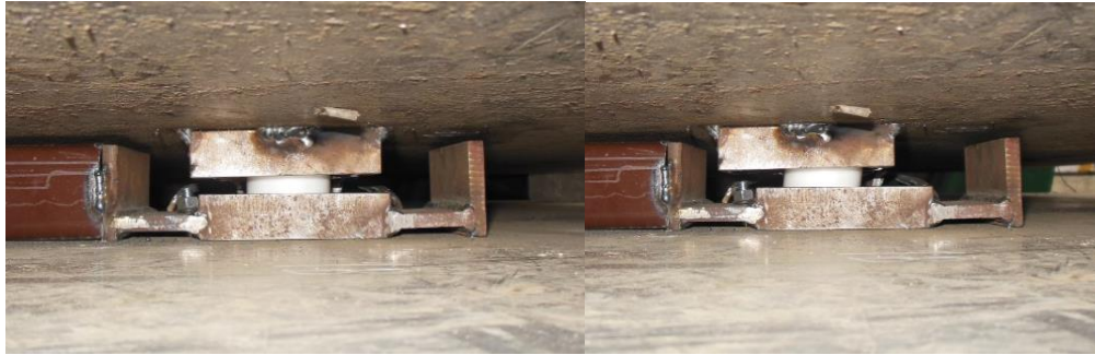
Figura 2. Detalle de aislador de doble curvatura con deslizador de teflón: posición inicial (izquierda) y posición desplazada (derecha).
