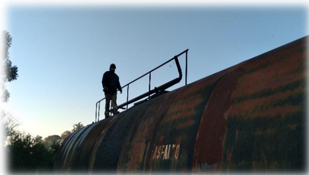
Tanque de Asfalto
