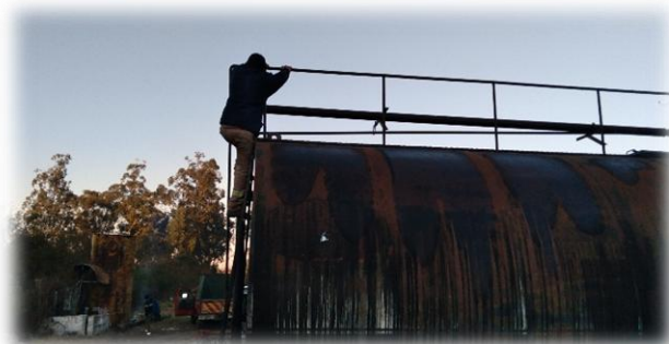
Tanque de Asfalto
