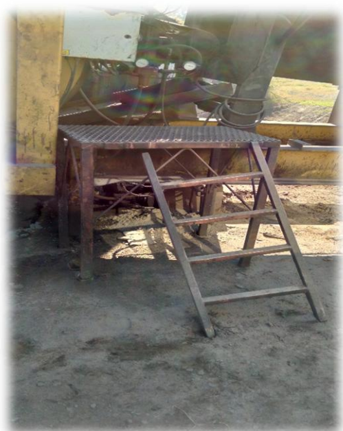
Escalera de encendido de caldera
