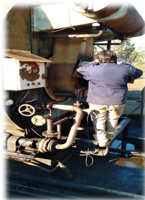
Encendido de caldera.
