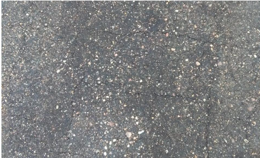
Figura 10. Fisuras de baja severidad por consolidación posterior. Fuente: elaboración propia
