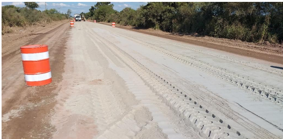
Figura 3. Distribución del contenido de cemento por encima de la capa de suelo roturada. Fuente: elaboración propia
