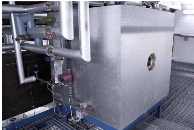
Ilustración 4.27. Tanque de almacenamiento del condensado. Fuente: https://yuandaboiler.en.made-in-china.com/product/UOwmdpYDbrWR/China-30-40-50-60-70-100-150-200-250-300-350-400-450-500-550-600-700-HP-Bhp-Precio-De-La-Caldera-De-Vapor-De-Gas-Natural-Diesel.html?ads_tp=
