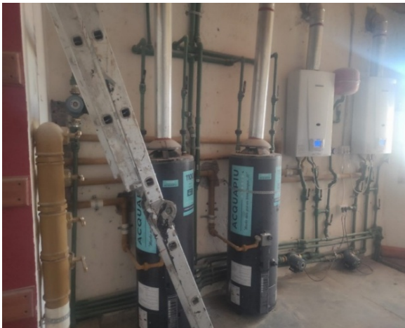
Foto 12 – Sala de máquinas
