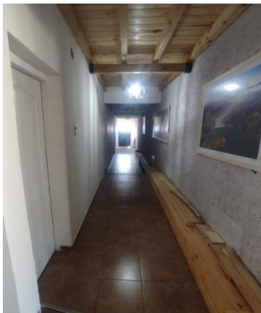
Imagen 2 – Escalones sin señalizar
