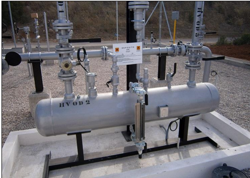
Sistema odorizador instalado
