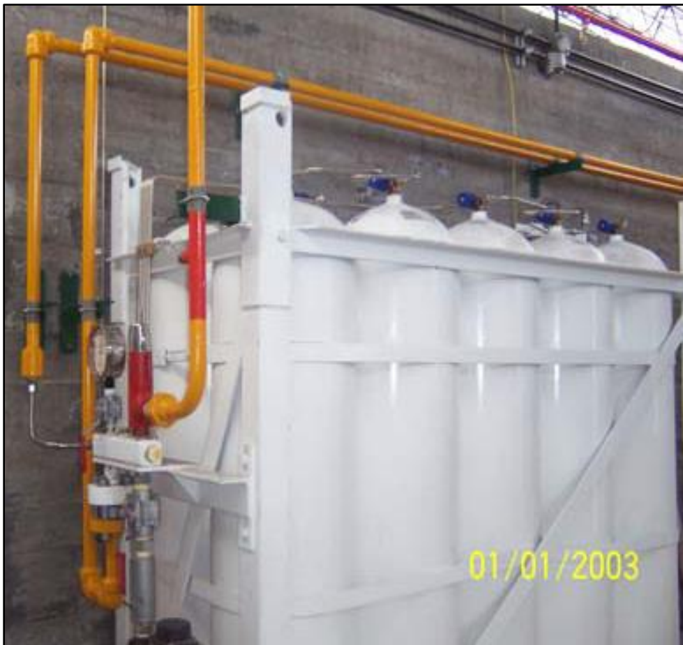
Tanques para almacenamiento de gas en estaciones de GNC.
