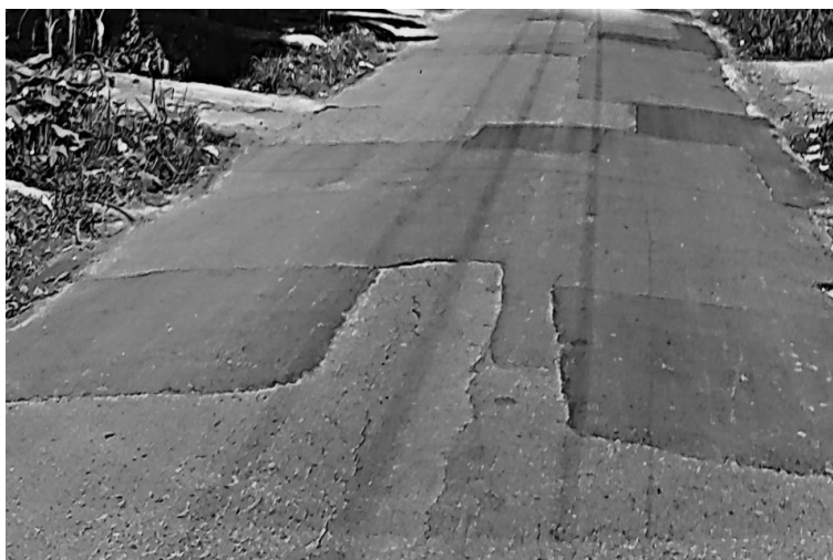
Figura 43.4. Campañas sucesivas de bacheo con terminación superficial inadecuada
