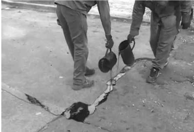
Figura 44.2. Distribución inadecuada de un sellador asfáltico
