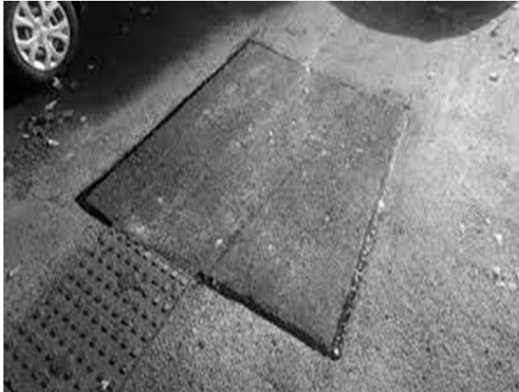
Figura 43.7. Bache con junta tomada con sellador asfáltico
