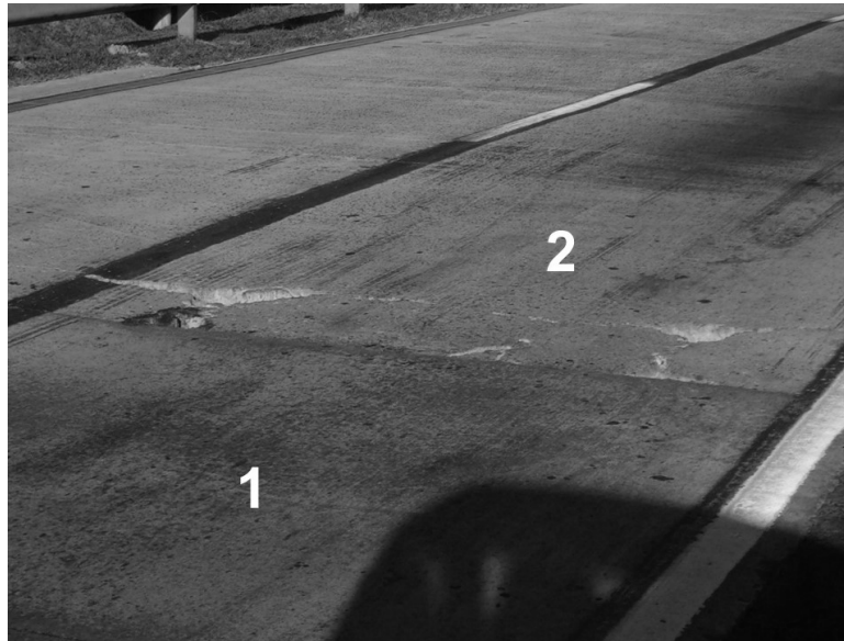
Figura 41.1. Caso típico de problema de demolición de losa
