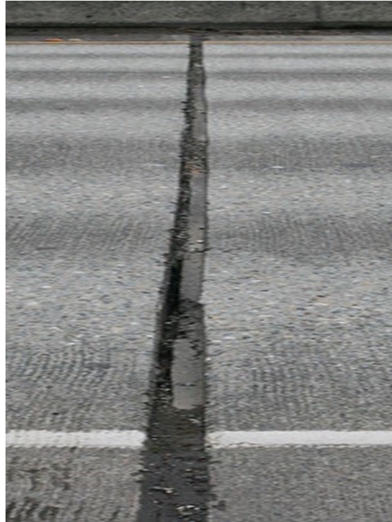
Figura 49.1. Recrecido de juntas por ingreso de material incompresible
