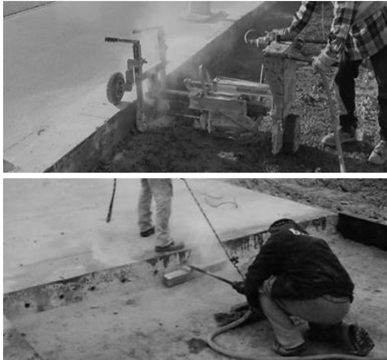
Figura 47.5. Perforaciones para armaduras en losas perimetrales con equipo especial (arriba) o del tipo manual (abajo)
