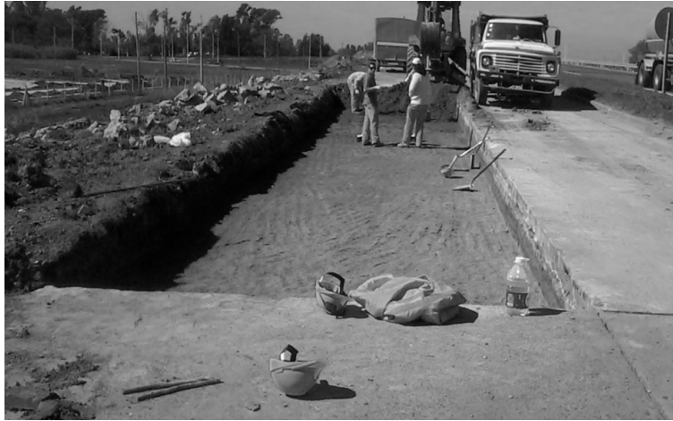
Figura 47.1. Área de intervención de bases afectadas coincidente con la superficie de la losa
