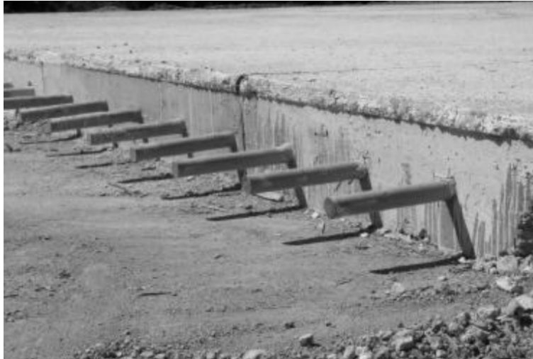
Figura 26.5. Pasadores en una junta de dilatación previo a ser engrasados
