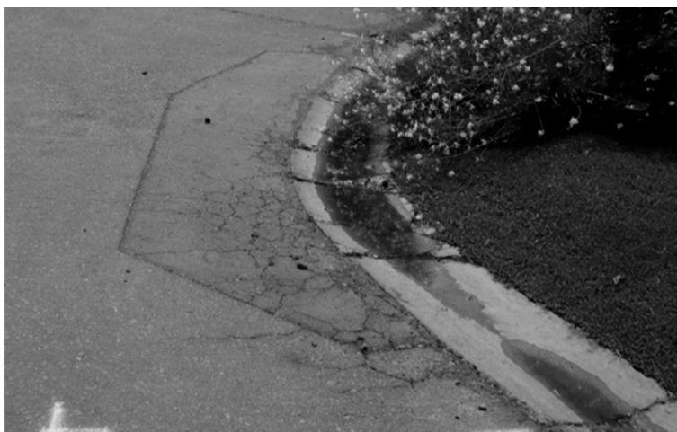
Figura 43.6. Sector bacheado con junta abierta al pavimento remanente
