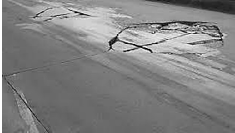
Figura 50.2. Fisura en esquina por bombeo y junta "sucia"
