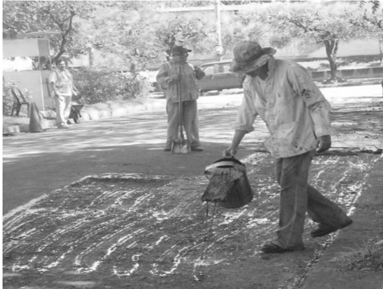
Figura 42.4. Aplicación inadecuada de un riego asfáltico en un bache
