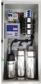
Imagen 132 - Banco de capacitores
