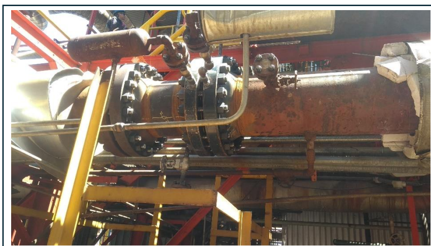
Fig. 15 - Modificación de tomas de caudalímetro en línea de V.A.
