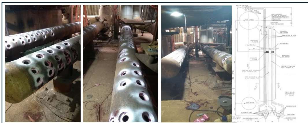
Fig. 9 - Colectores del sobrecalentador con revelador de las tintas penetrantes. Extracto de plano constructivo del fabricante del sobrecalentador completo con las espiras y tubos de alimentación desde el domo superior.
