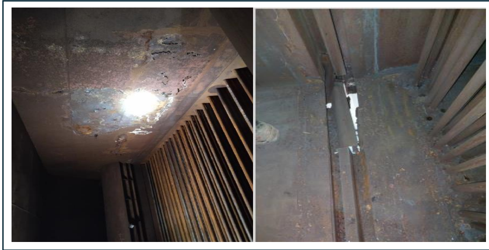
Fig. 10a - Ductos de aire y juntas de dilatación.
