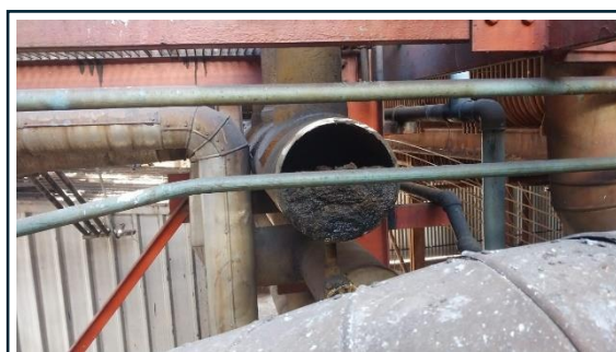
Fig. 16 - Línea de gas natural obstruida.
