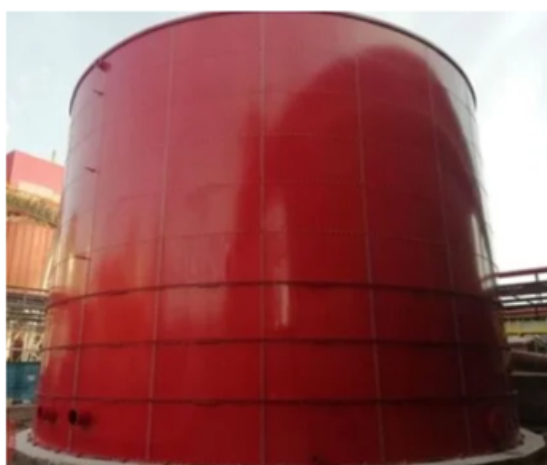
Figura 20: Tanque de almacenamiento de acero
