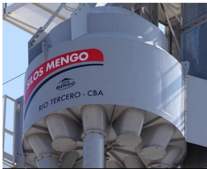
Figura 18: distribuidor de descarga de noria
