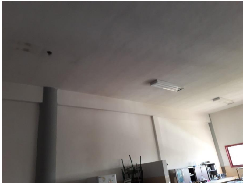
Iluminación deficiente por faltante de equipo de iluminación
