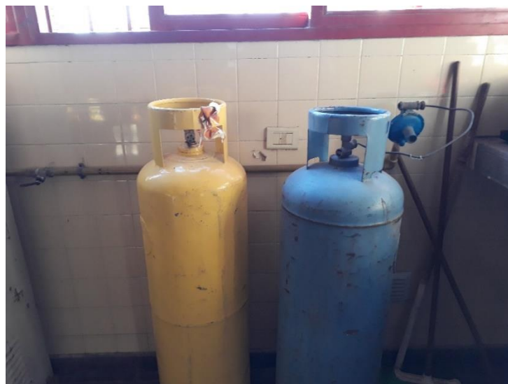
Tubos de gas sin sujetar y próximos a tomacorrientes eléctricos
