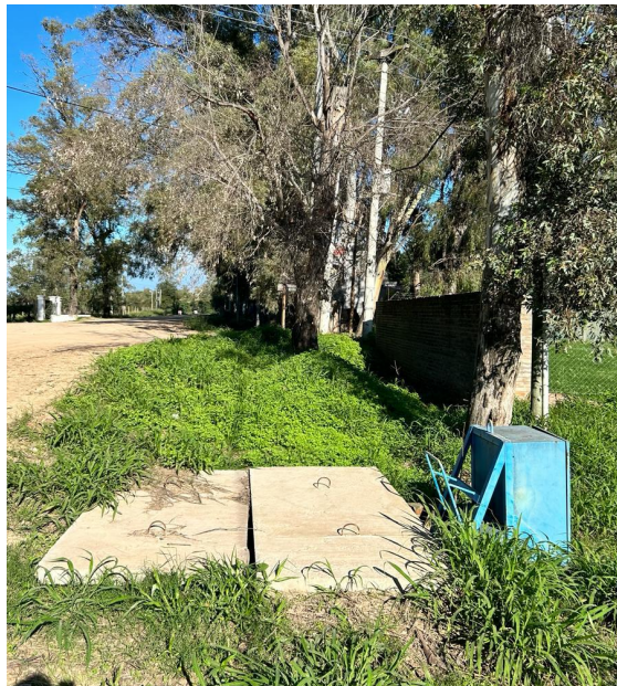
Estación de Bombeo 1 - Sta Rosa y Cjón. Pintos
