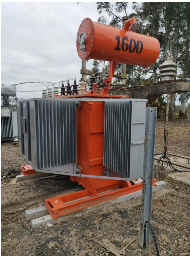
4 Nuevo Transformador de 1600 kVA a poner en servicio
