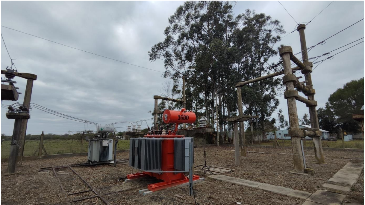
6 Vista general de la ET por dentro
