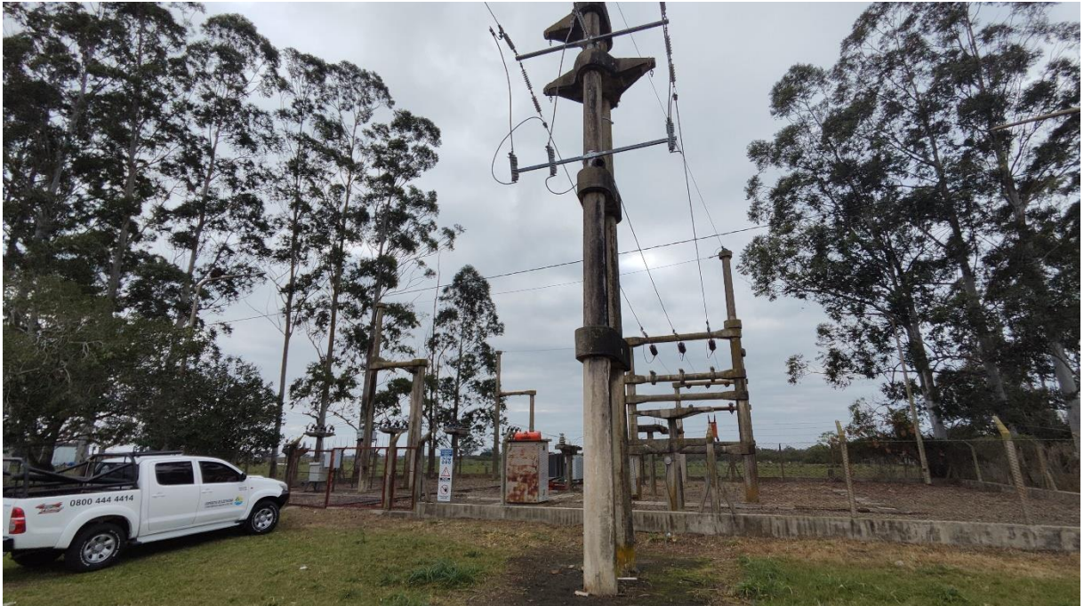
2 Vista general de la estación transformadora Tacuara
