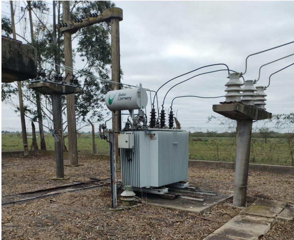
5 Transformador en funcionamiento de 1000 kVA
