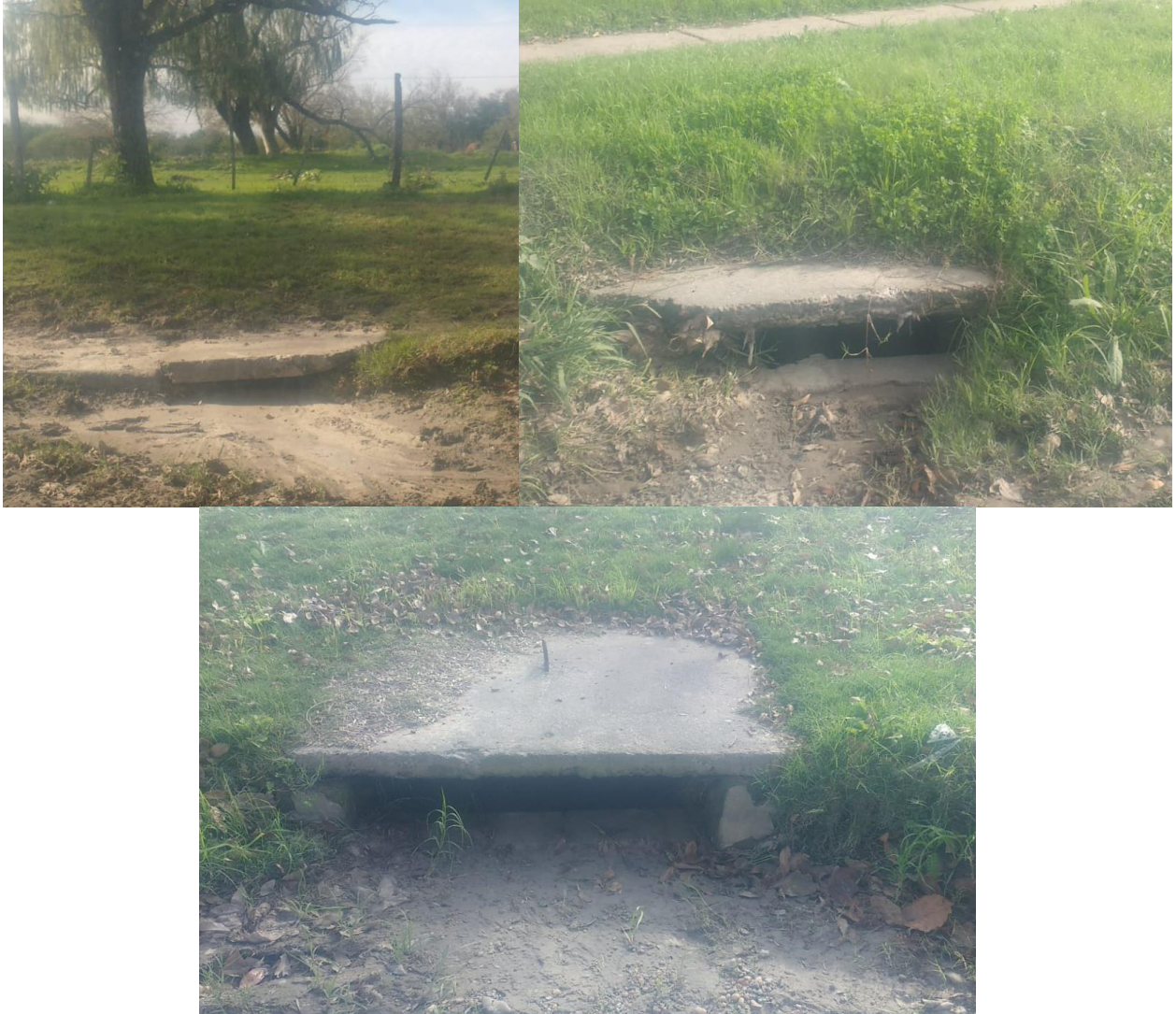
Imágenes N°69, N°70 y N°71 - Bocas de tormenta sobre los conductos secundarios
