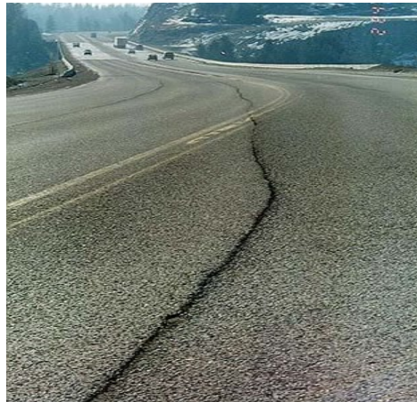
Figura 3.6. Fisura longitudinal. (Corros et al., 2009)
