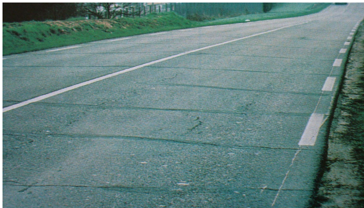
Figura 3.4. Fisuración por reflejo de fisuras. (Martínez et al., 2018)
