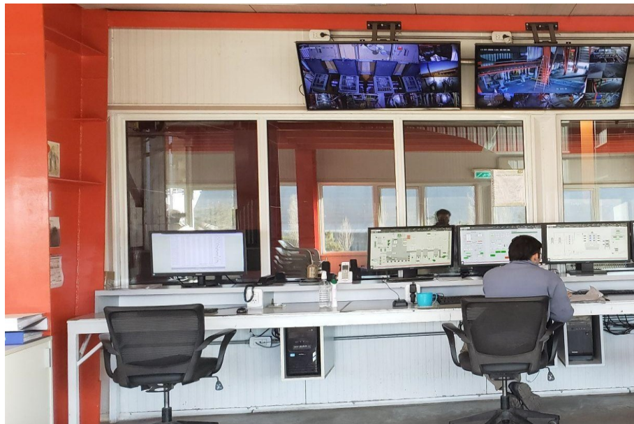
Figura N°1.41: Vista de operario en sala de control de caldera.
