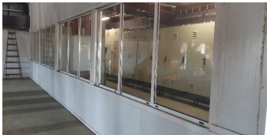
Figura N°1.21: Tableros de control.
