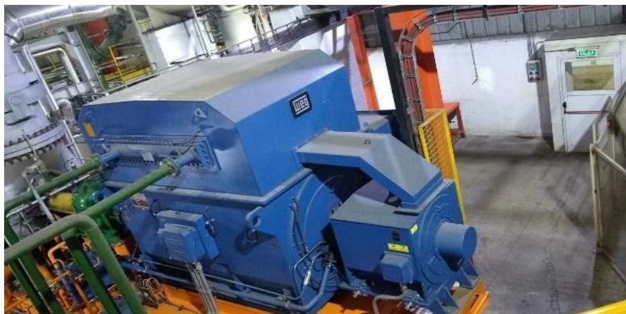
Figura N°1.19: Generador eléctrico (WEG-ST40).
