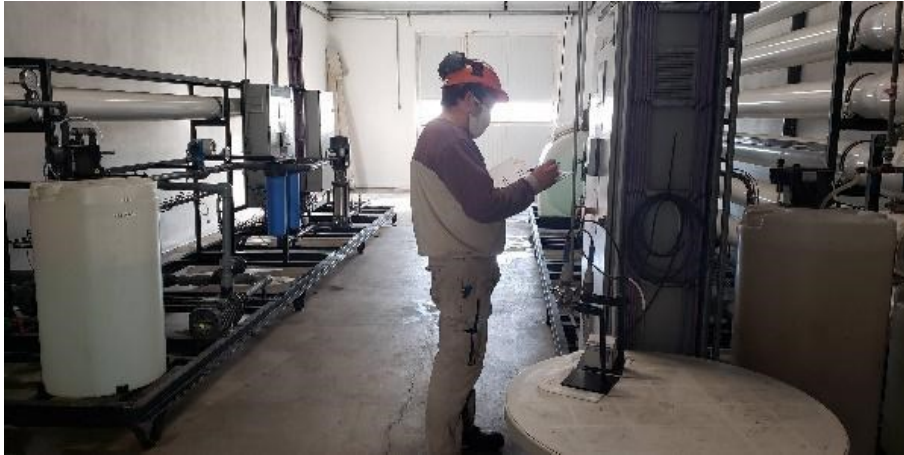
Figura N°1.22: Sector Tratamiento de agua. Osmosis inversa.
