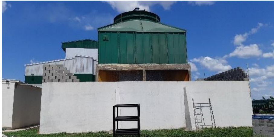
Figura N° 1.17: Torre de enfriamiento de 1200 m 3 /h.
