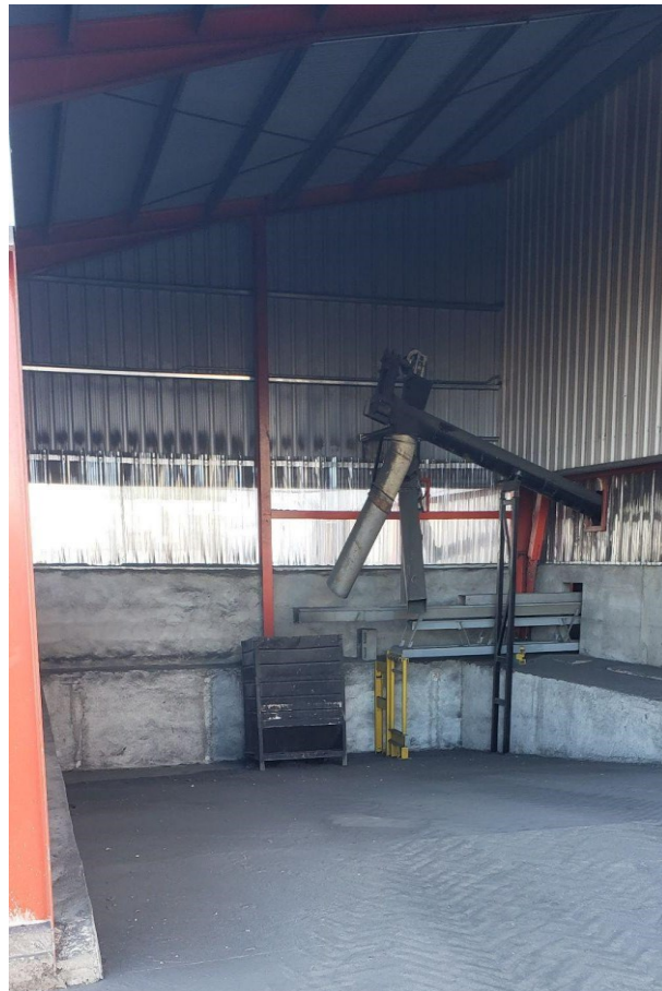
Figura N° 1.39: Vista de descarga de ceniza sobre capacho metálico.
