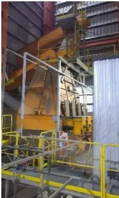
Figura N° 1.7: Tolva. Capacidad de 10 m 3 .
