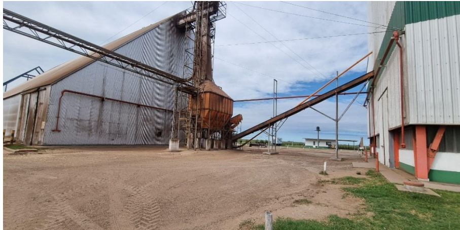
Figura N° 1.40: Vista de caño aéreo de ingreso por soplado hacia tolva pulmón.
