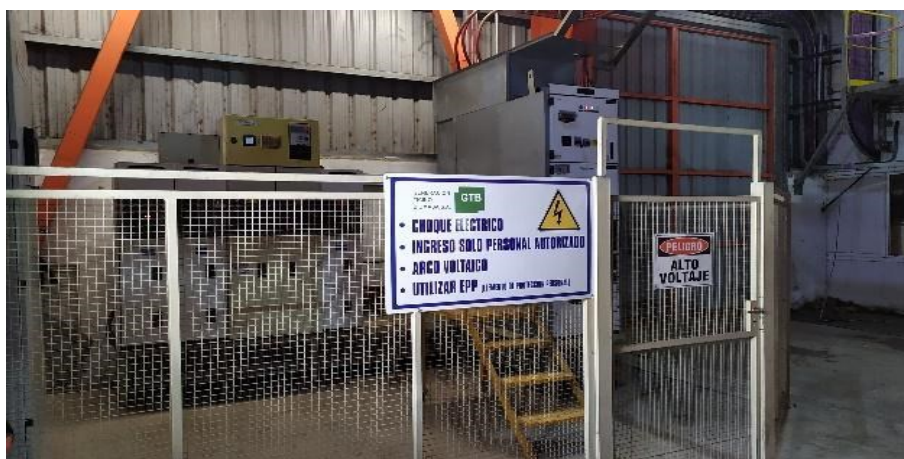
Figura N°1.20: Celda de Media Tensión. Capacidad 13200 V.
