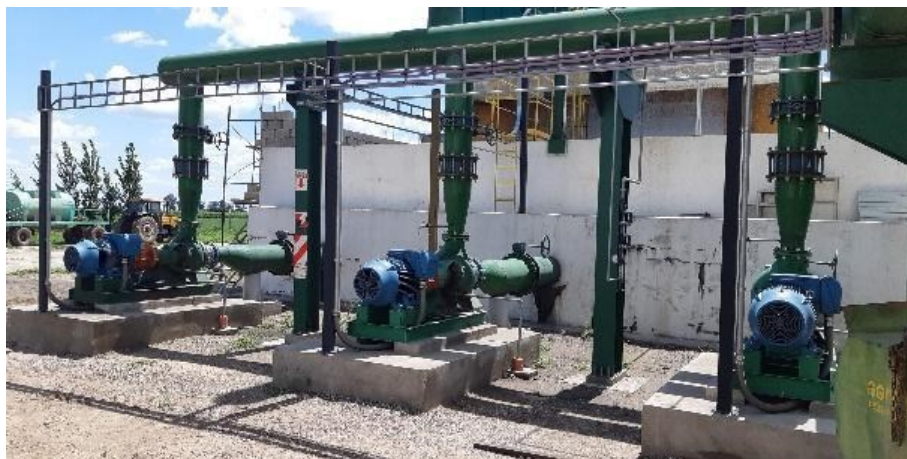
Figura N°1.18: Bombas de agua 600 m 3 /h
