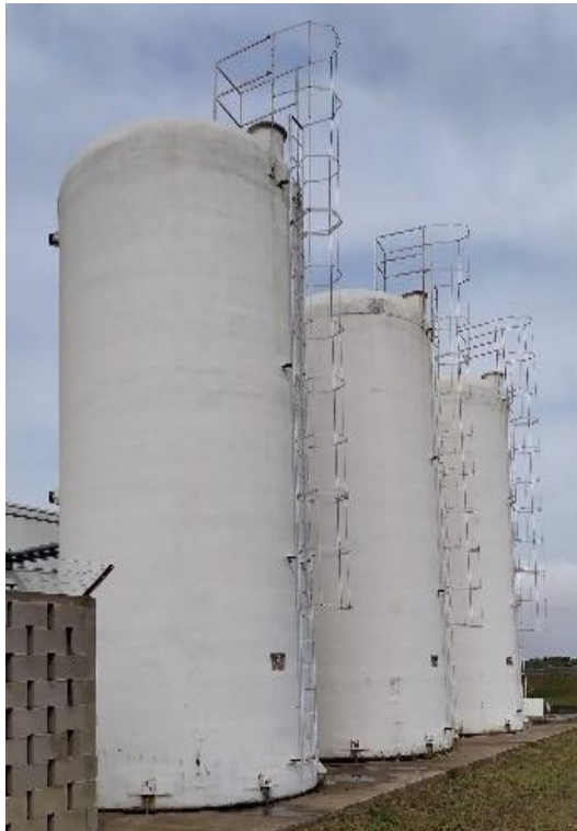
Figura N°1.23: Tanques de agua. Osmosis inversa.
