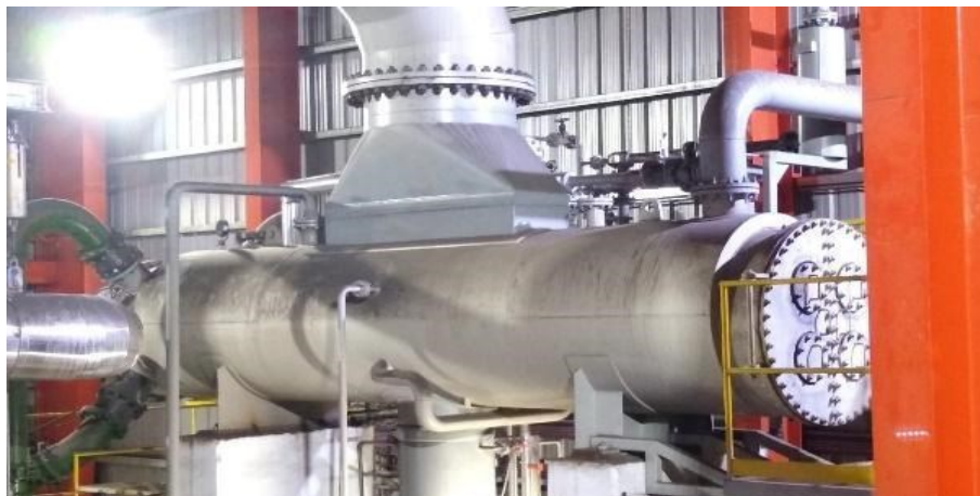
Figura N°1.16: Condensador (Marca TGM).
