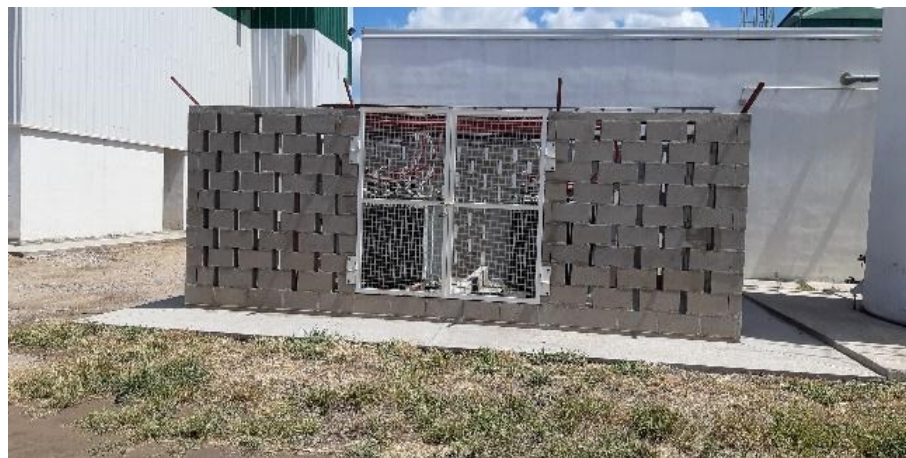
Figura N°1.26: Transformadores de 380 V (provisión de energía eléctrica a la Planta de GTB).
