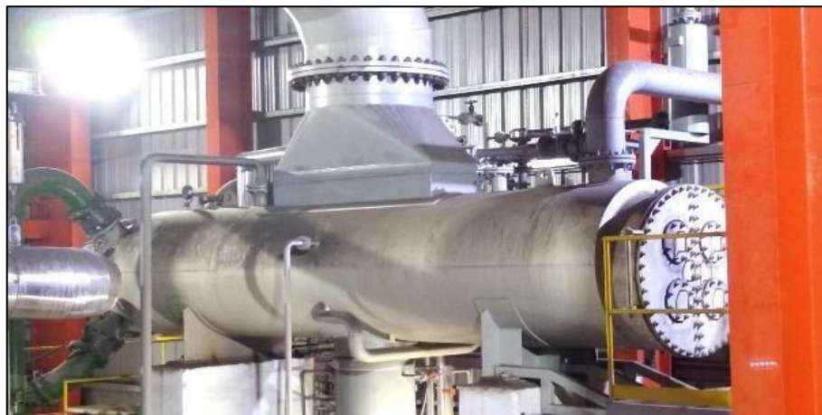
Figura N°1.16: Condensador (Marca TGM).
