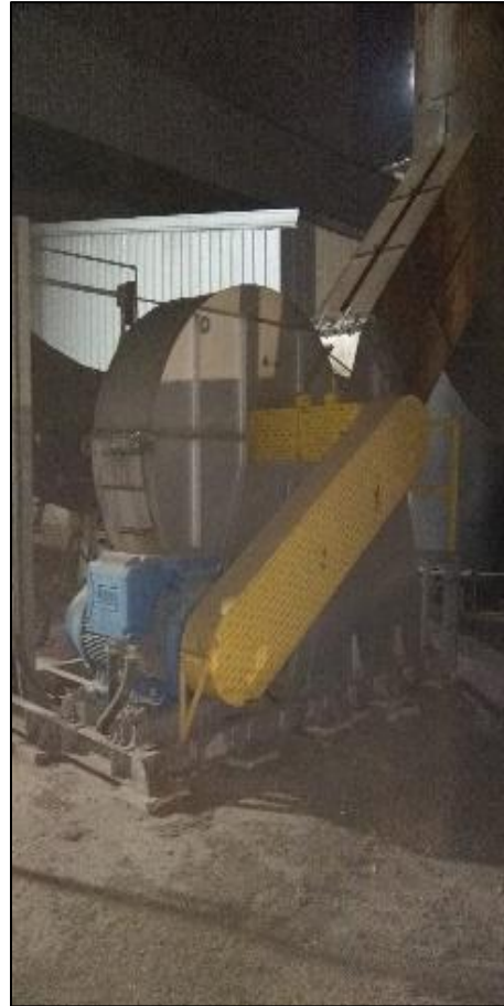
Figura N°1.12: Ventilador Tiro Forzado (VTI)
