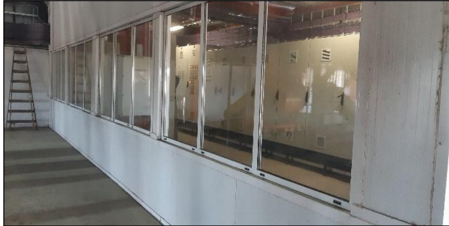
Figura N°1.21: Tableros de control.
