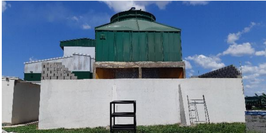
Figura N° 1.17: Torre de enfriamiento de 1200 m 3 /h.
