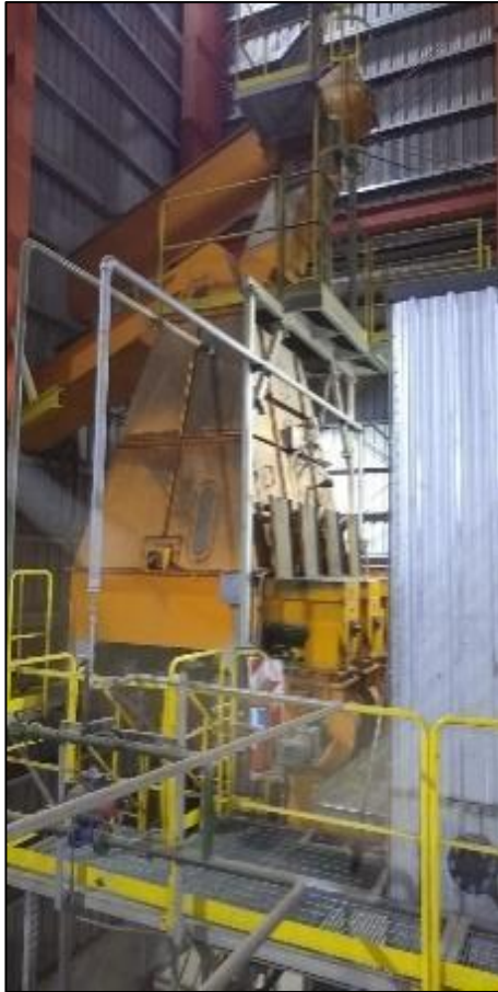
Figura N° 1.7: Tolva. Capacidad de 10 m 3 .
