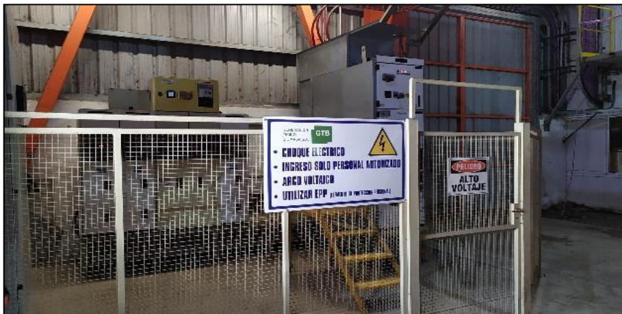
Figura N°1.20: Celda de Media Tensión. Capacidad 13200 V.
