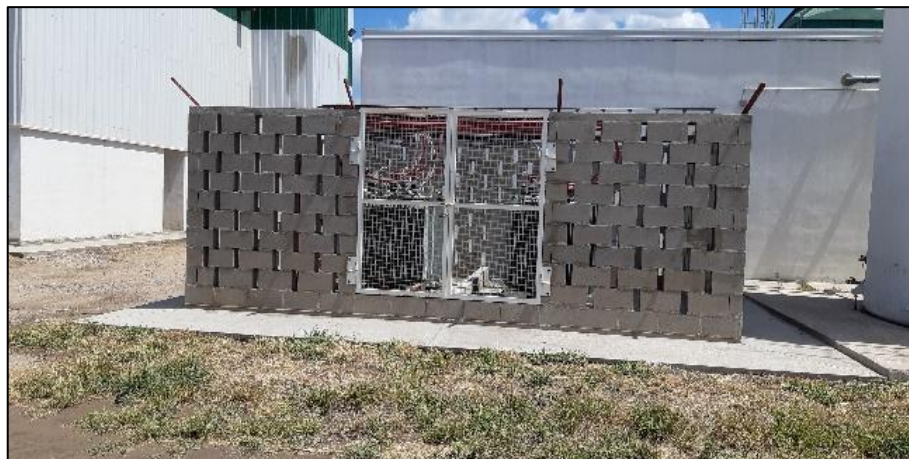
Figura N°1.27: Transformadores de 380 V (provisión de energía eléctrica a la Planta de GTB).
