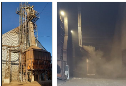
Figura N° 3.15: Vista de tolva pulmón 50 m 3 y boca de rebalse-interior de celda.
