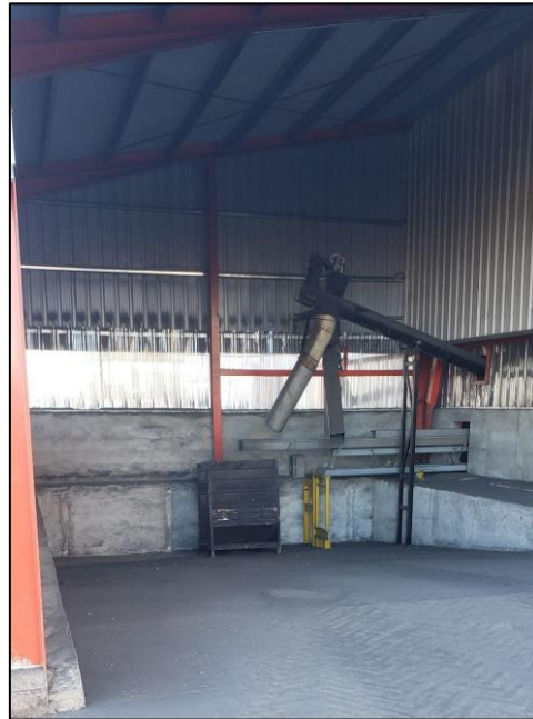
Figura N° 2.5: Vista de descarga de ceniza sobre capacho metálico.
