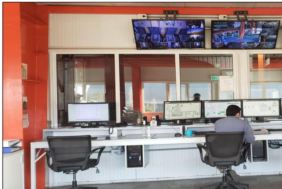
Figura N°2.7: Vista de operario en sala de control de caldera.
