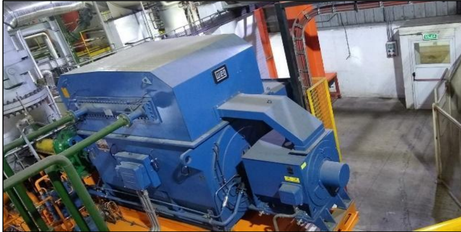
Figura N°1.19: Generador eléctrico (WEG-ST40).
