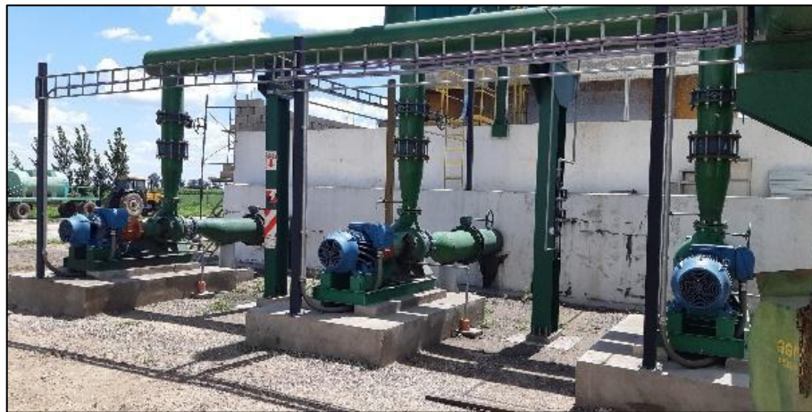
Figura N°1.18: Bombas de agua 600 m 3 /h
