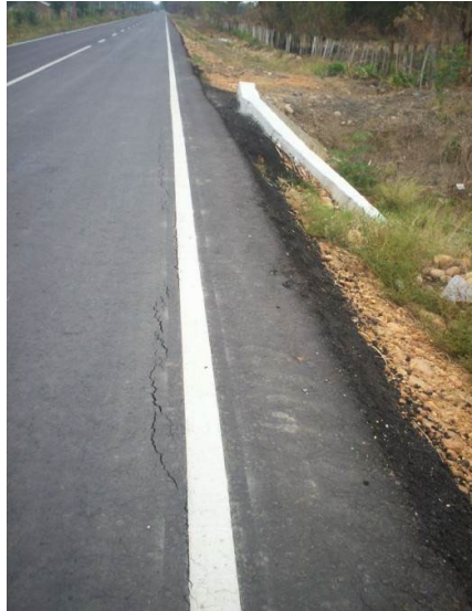
Figura 3.5. Fisuras de borde. (Corros et al., 2009)
