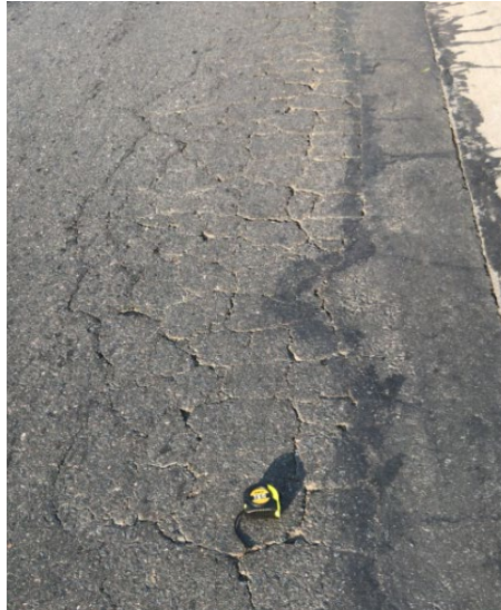
Figura 3.3. Fisuración por fatiga en huella derecha de calzada. (Fuente propia)
