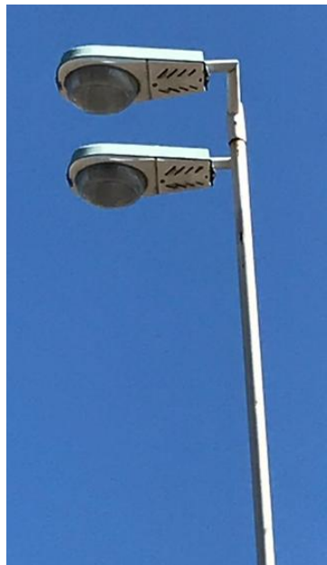
Figura 8: Artefactos instalados en poste ubicado en Ruta Nacional N°8, en el partido de Malvinas Argentinas. Fuente: Elaboración propia, Año 2018.
