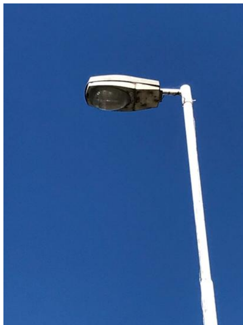
Figura 85: Artefacto instalado en poste ubicado en Ex Ruta Nacional N°202, en el partido de Malvinas Argentinas. Fuente: Elaboración propia, Año 2018.
