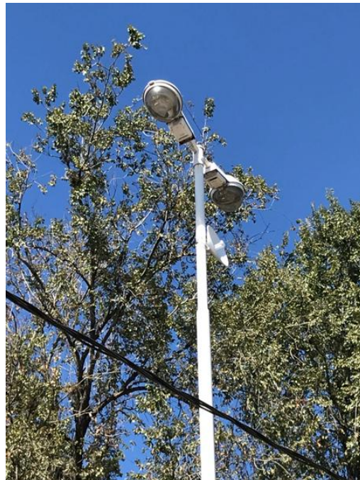
Figura 83: Artefactos instalados en poste ubicado en Av. Presidente Juan Domingo Perón, en el partido de Malvinas Argentinas. Fuente: Elaboración propia, Año 2018.
