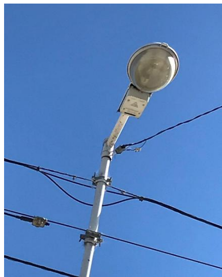
Figura 20: Artefacto instalado en poste ubicado en Calle Eva Perón, en el partido de Malvinas Argentinas. Fuente: Elaboración propia, Año 2018.
