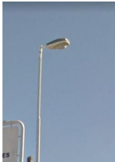
Figura 10: Artefactos instalados en poste ubicado en Avenida del Libertador General San Martín, en el partido de Malvinas Argentinas. Fuente: Elaboración propia, Año 2018.
