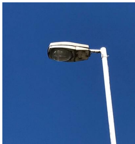
Figura 2: Artefacto instalado en poste ubicado en Ex Ruta Nacional N°202, en el partido de Malvinas Argentinas. Fuente: Elaboración propia, Año 2018.
