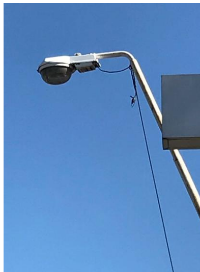
Figura 6: Artefacto instalado en poste ubicado en Ruta Nacional N°8, en el partido de Malvinas Argentinas. Fuente: Elaboración propia, Año 2018.
