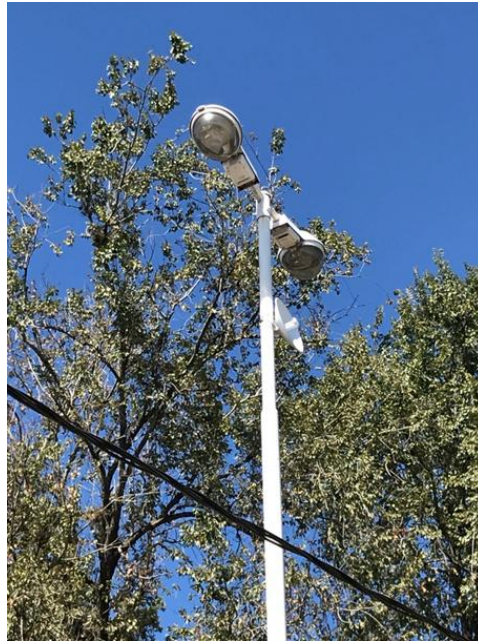
Figura 15: Artefactos instalados en poste ubicado en Av. Presidente Juan Domingo Perón, en el partido de Malvinas Argentinas. Fuente: Elaboración propia, Año 2018.
