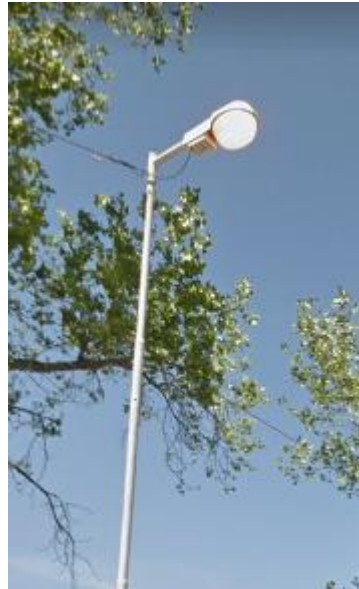
Figura 23: Artefacto instalado en poste ubicado en Calle Eva Perón, en el partido de Malvinas Argentinas. Fuente: Elaboración propia, Año 2018.
