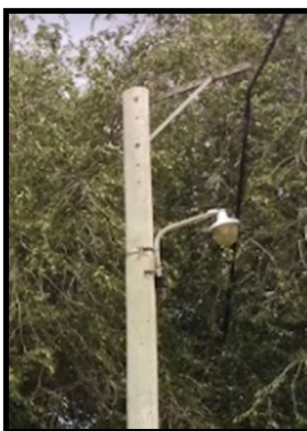
Imagen 29. Luminaria Barrio La Tosquera – Fuente: elaboración propia.
