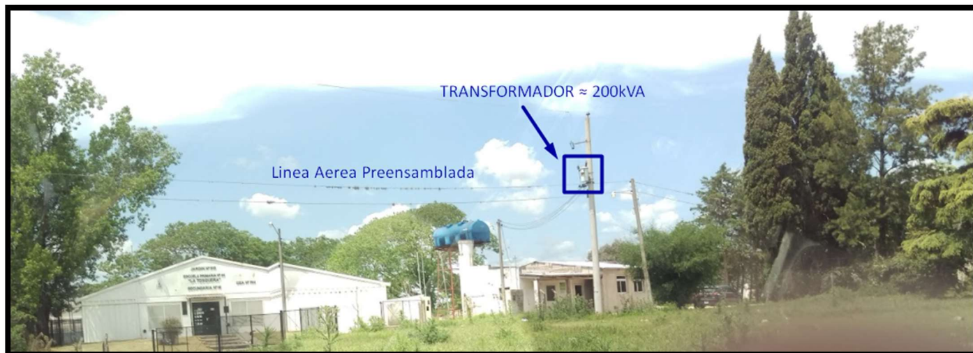
Imagen 28. Tendido eléctrico – Fuente: elaboración propia.
