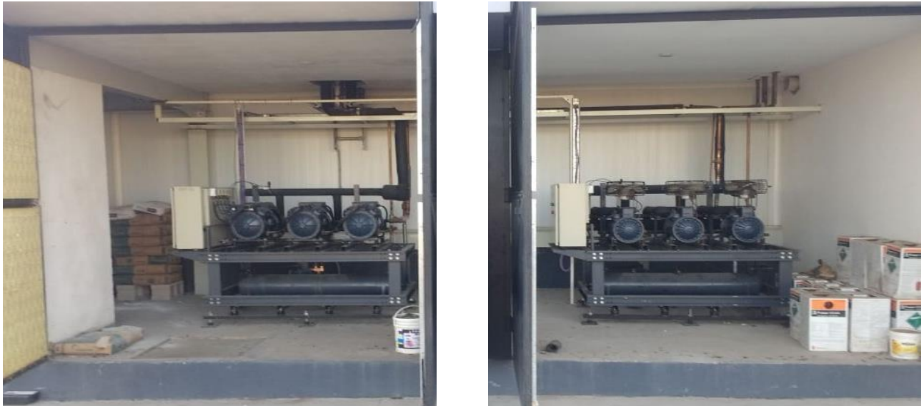
Figura 1.27. Central de enfriamiento 1 y 2.
