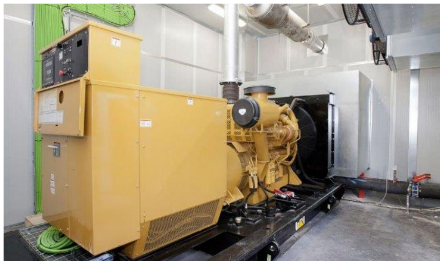
Ilustración 88 - Generador de potencia continua. Fuente: https://www.ventageneradores.net , 2020.
