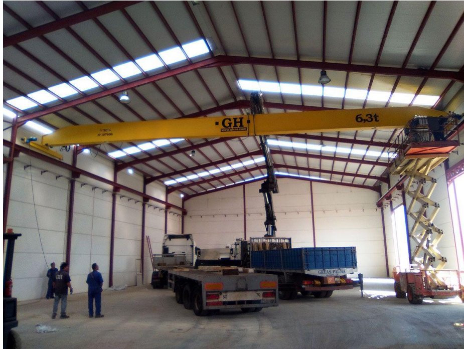
Ilustración 91 - Puente grúa. Fuente: Google imágenes.
