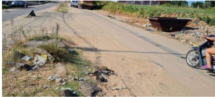
Figura N° 7: Cantero central de calle P.A. de Sarmiento (deteriorado y con basura)
