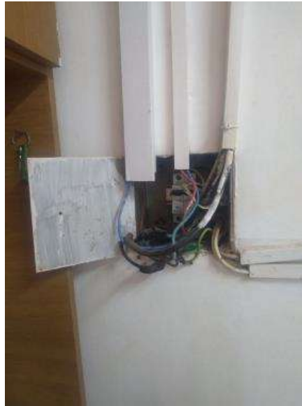
Figura N° 27: Tablero Eléctrico (Dirección)
