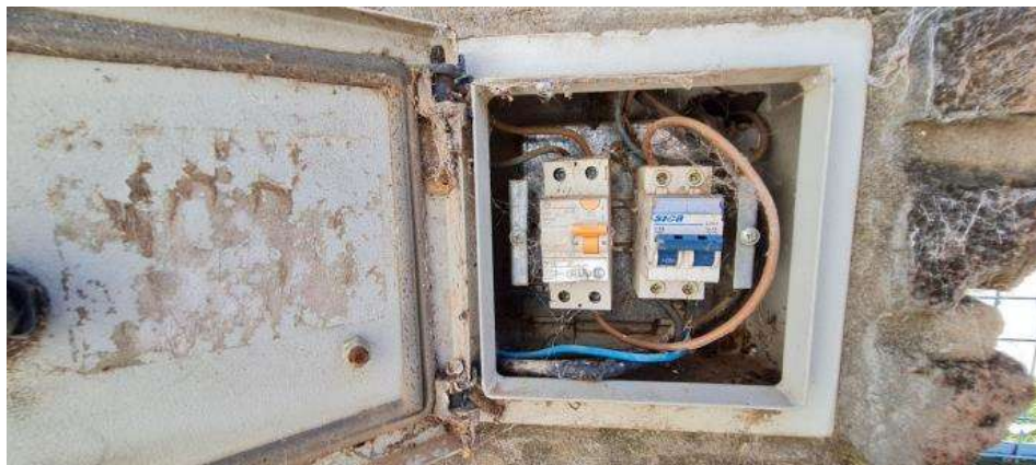
Figura N° 28: Tablero Eléctrico (Ingreso)
