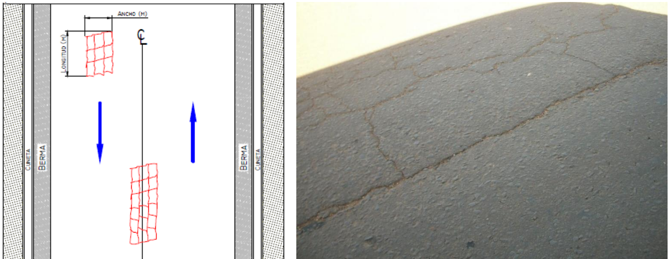
Imagen 4 - Fisuras en bloque sobre pavimento asfáltico existente
