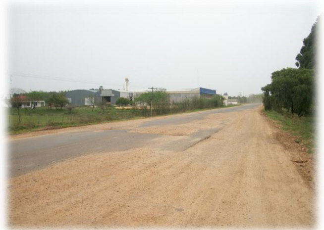
FOTO 02: Estado del perfil de la ruta en el primer tramo, entre prog. 0+000 / 1+000.
