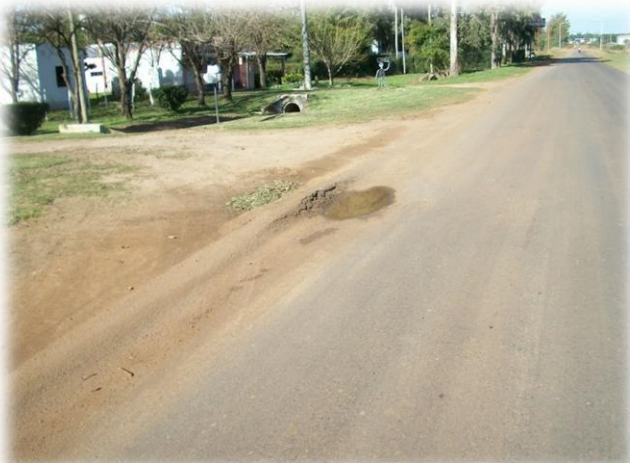
FOTO 09: Ahuellamiento en el tramo prog. 5+000 / 6+290. Zona urbanizada B° Tacuabe y B° Militar.
