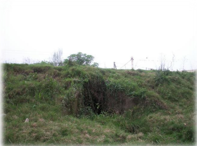
FOTO 03: Estado de las alcantarillas existentes de hormigón c/cabezas.
