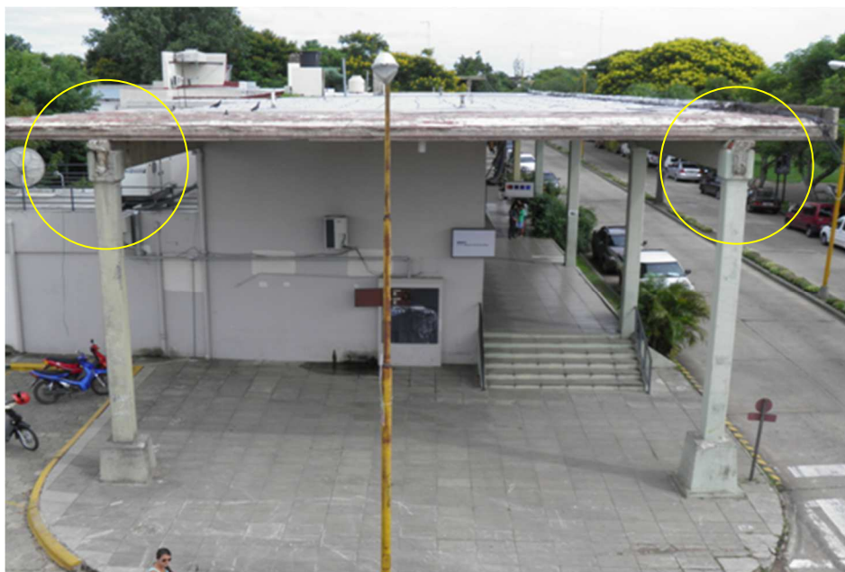
Figura N°2: Vista general de la sección de colapso.
