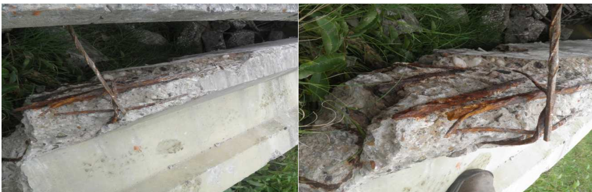
Figuras N°6 y N°7: Vista ménsula y zona de ruptura. Vista en detalle de la zona de ruptura y estado de corrosión sobre armaduras principales.
