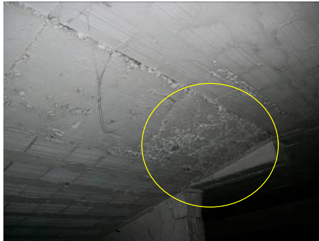
Foto 14 – Oquedades en Losa de Rampa al 2º SS
