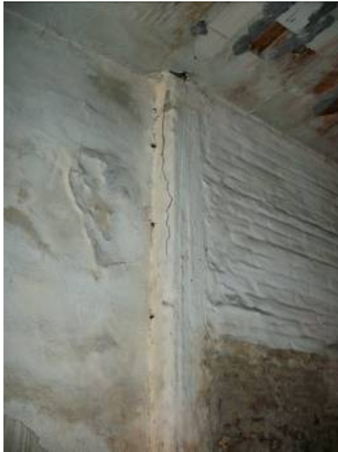
Foto 11 – Columnas C11 y C16
