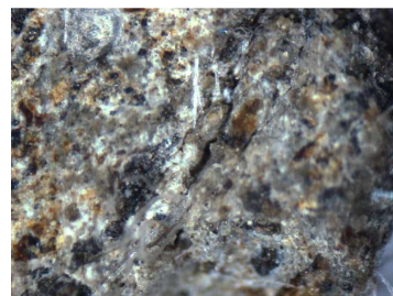
Microfoto 3 – Con fibras de polipropileno, fibras sobre zona de fisuras.
