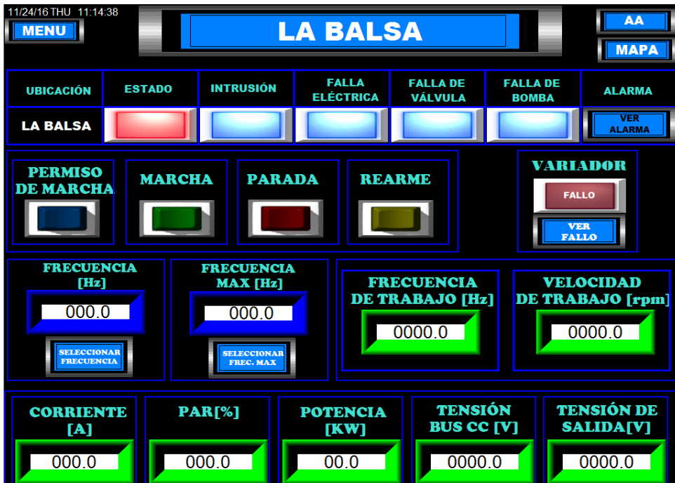
Fig. 40 Pozo Comandado con Variador de Frecuencia
