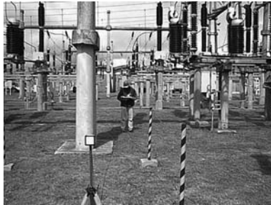
Fig.1: Procedimiento de medición de campo eléctrico dentro de una ET.
