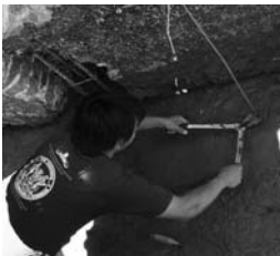
Figura 4 a) – Colocación de sensores
