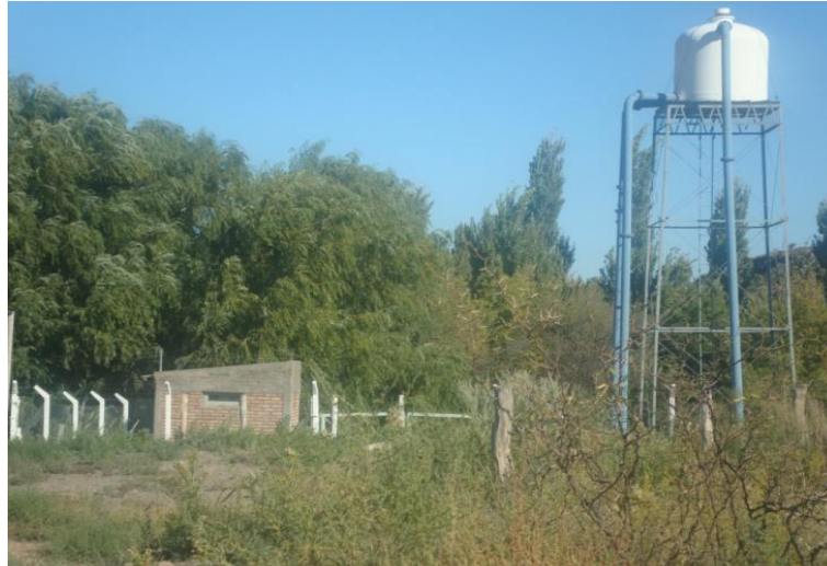
Figura 8 Planta potabilizadora de agua
