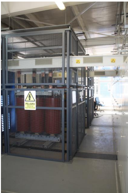
Imagen: Transformadores secos de 1MVA
