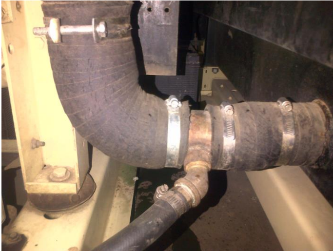
Imagen: Observe las grietas en la manguera.
