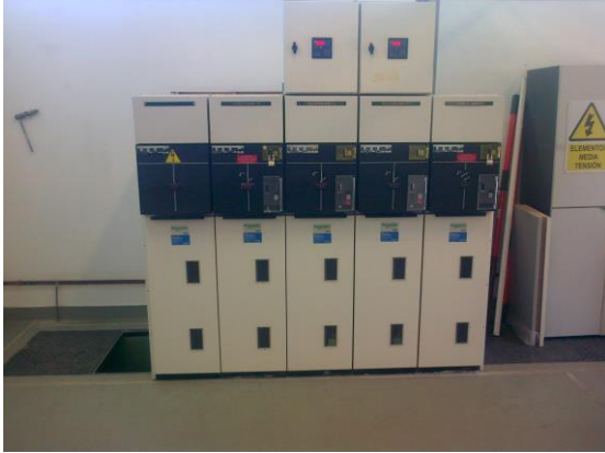
Imagen: estado final del tren de celdas
