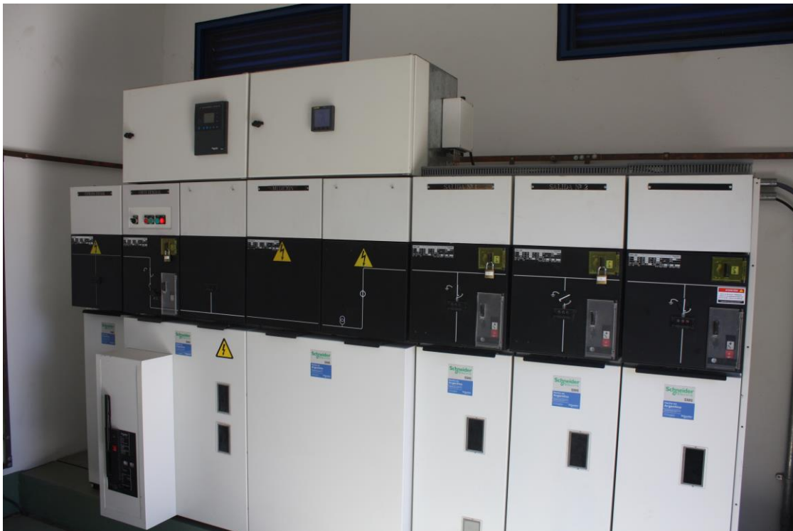
Imagen: Tren de celdas de entrada.
