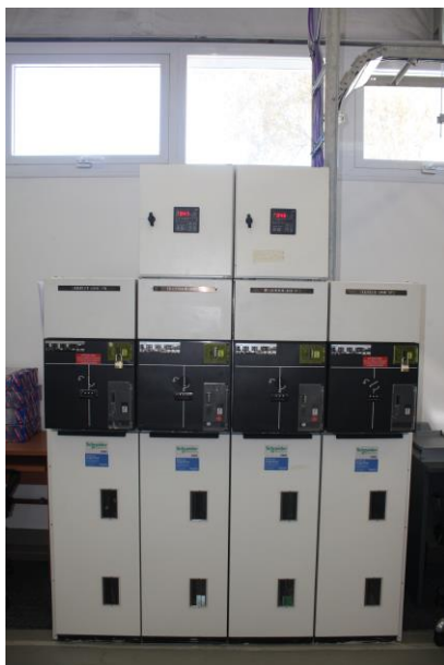
Imagen: Tren de celdas edificio generación
