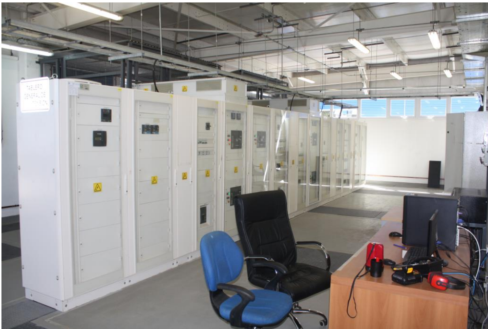
Imagen: TGBT (tablero general de baja tensión)
