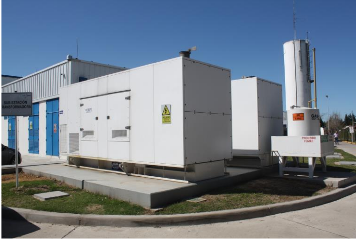
Imagen: grupos electrógenos encabinados, que se ubican fuera del edificio de generación. Se trata de dos grupos electrógenos de 800 y 900 KVA.
