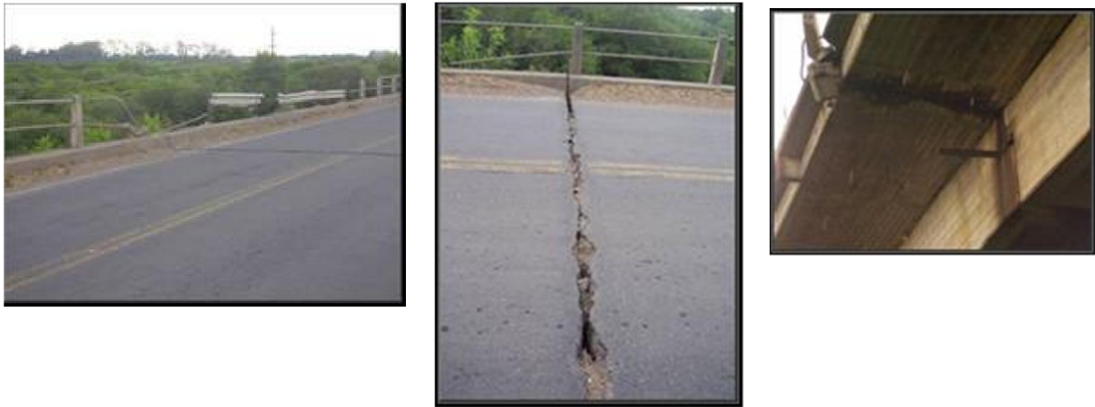
Fig 8- Vista de afectaciones en las barandas metálicas (izq.), del estado de la junta superior e inferior en tablero y de los dispositivos de apoyos (centro y der.).
