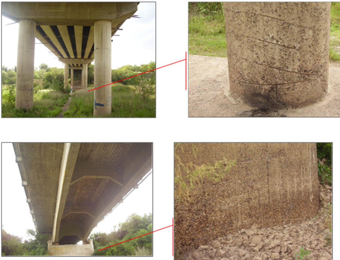
Fig 6- Vista inferior de columna en pila (sup.) y de tabique de pila (inf.), en las cuales se observa una importante remoción de pasta de cemento dejando a la vista no solo los áridos sino parte de los estribos.
