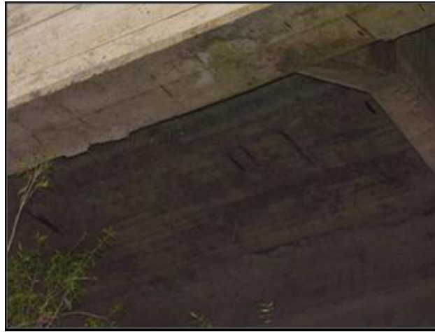
Fig 4- Vista inferior de tablero y vigas con armadura visiblemente afectados por procesos corrosivos.
