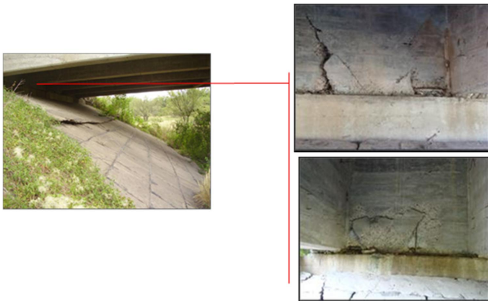
Fig 9- Vista de estribo descalzado (izq.) y de la viga sobre el estribo (der.).
