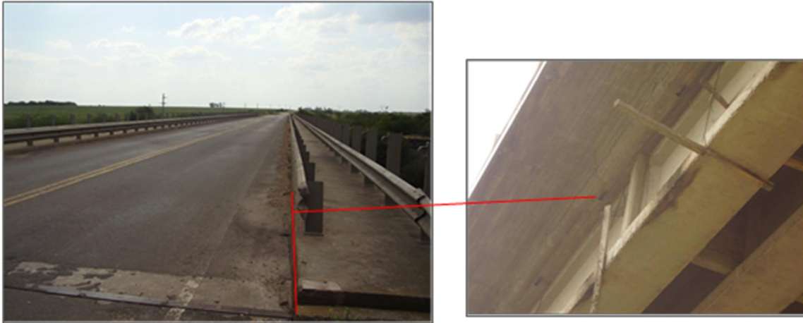
Fig 5- Vista de la falta de mantenimiento y mala práctica de construcción en los desagües.
