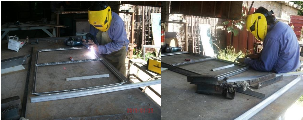
Imagen N°46: Uso de Máquina de soldar TIG Fuente: Elaboración propia – Fotografía tomada in situ
