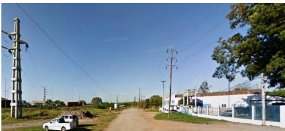
Imagen N°6: Redes de Media y baja tensión en zona de camino de R.N.N°11
