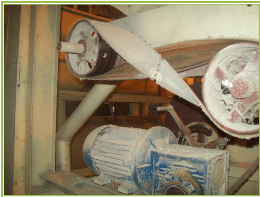
Gráfico N°58: Riesgo Mecánico: Poleas sin resguardo
