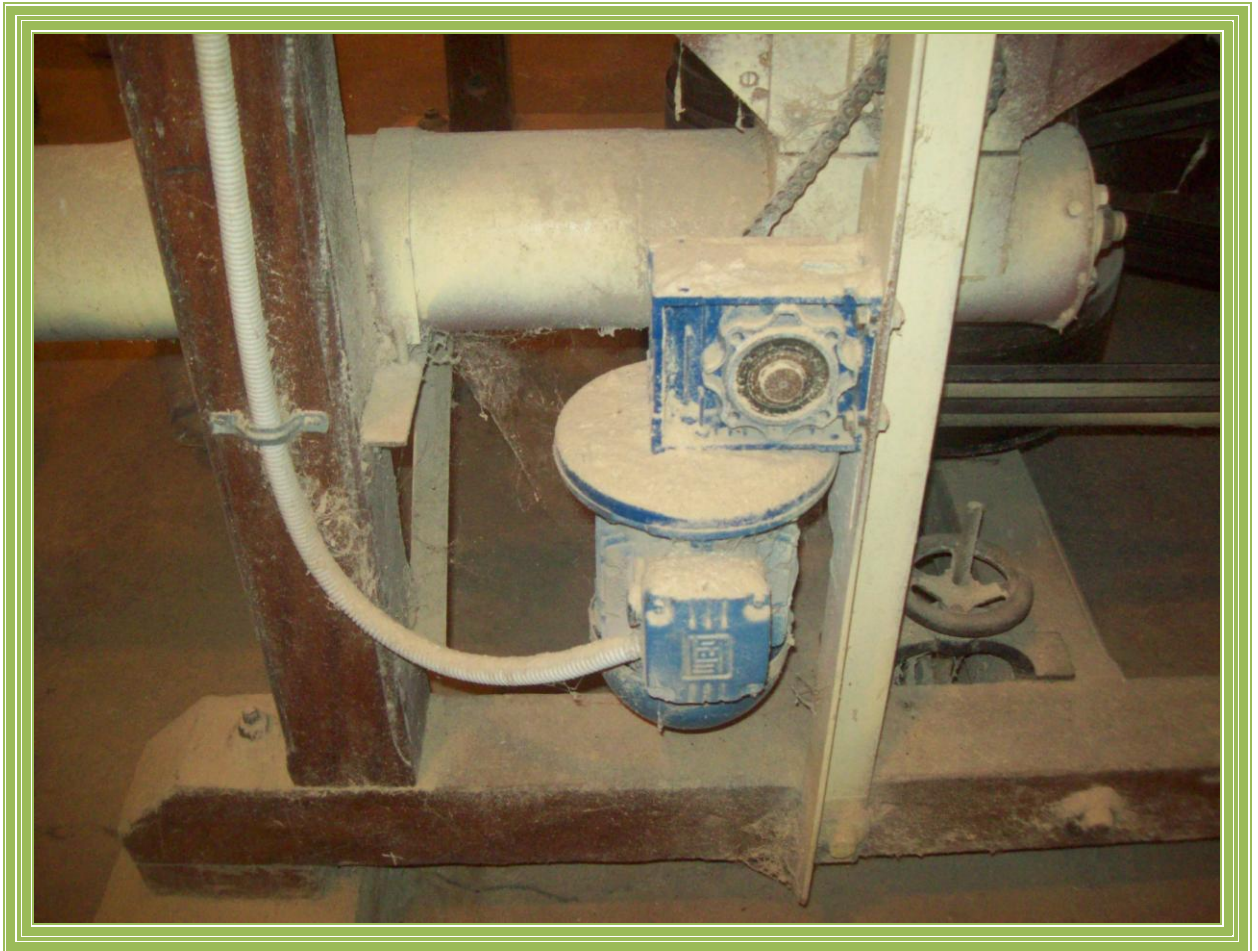
Gráfico N°46: Riesgo eléctrico “motor eléctrico sin mantenimiento”
