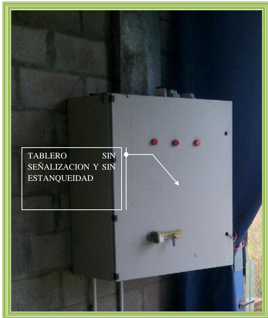
Gráfico N° 41: Riesgo eléctrico “vista frontal tablero general”
