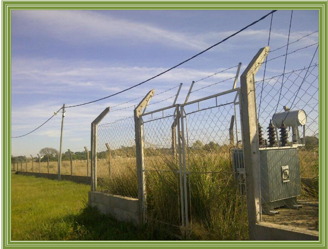
Gráfico N°8: Transformador dentro del predio
