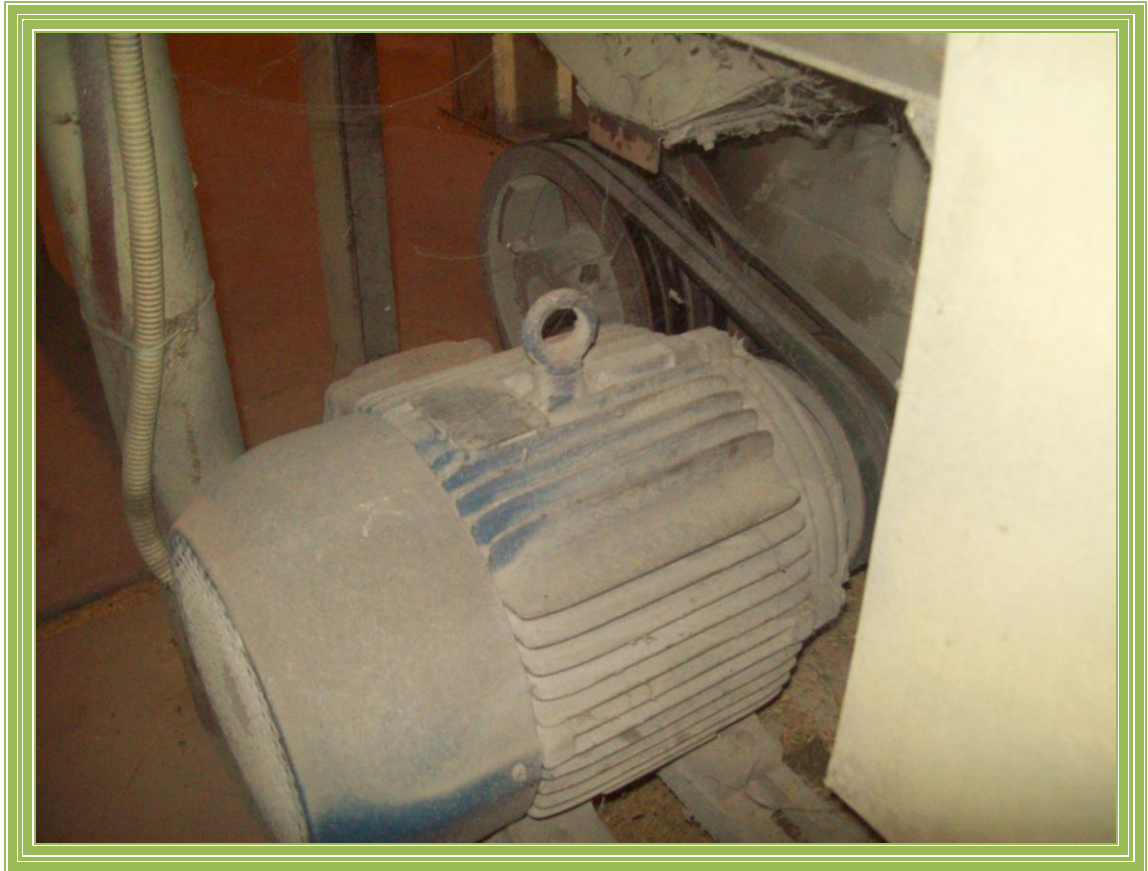
Gráfico N°45: Riesgo eléctrico “motor eléctrico expuesto al polvo y humedad”
