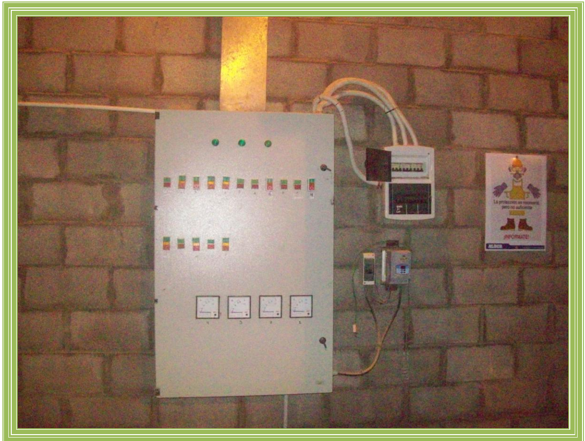
Gráfico N°43: Riesgo eléctrico “vista frontal tablero de mando molino de arroz.”
