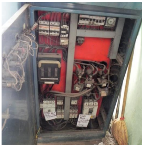
Fotografía 6.2 – Tablero principal 2 – Elaboración propia
