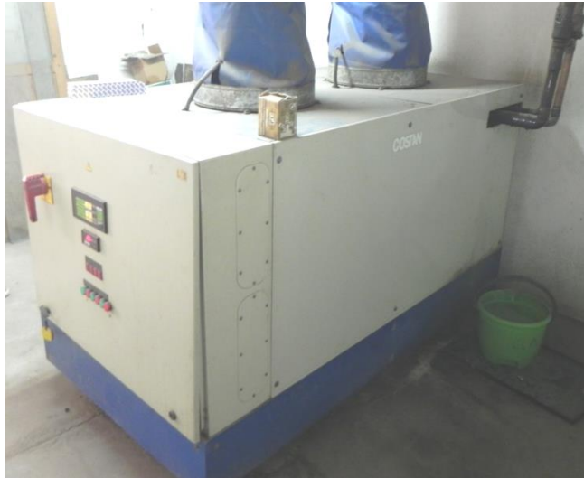
Fotografía 5.4 – Compresores – Elaboración propia
