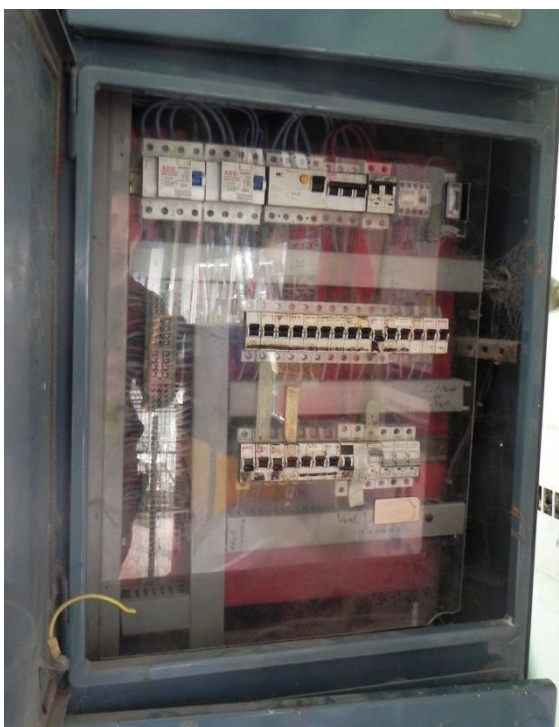
Fotografía 6.4 – Tablero principal 3 – Elaboración propia
