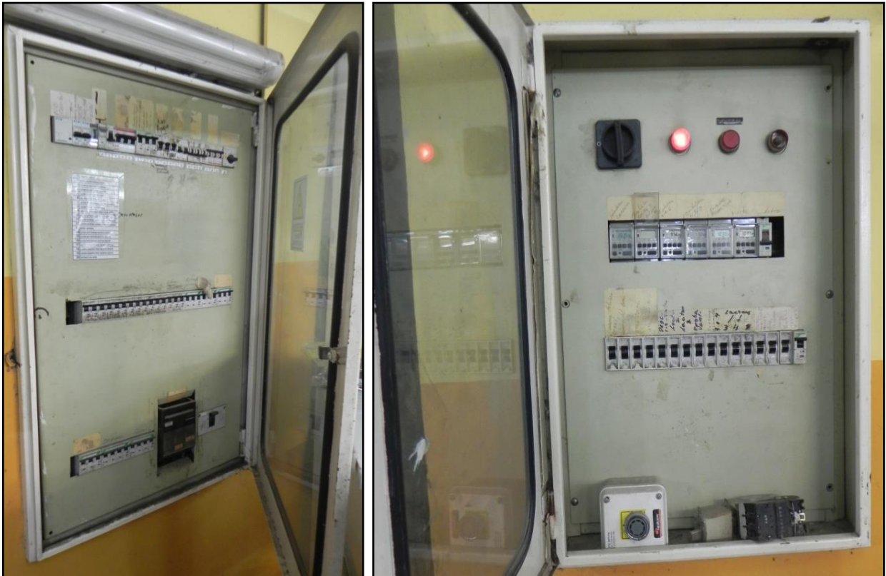
Fotografía 6.5 y 6.6 – Tableros secundarios – Elaboración propia
