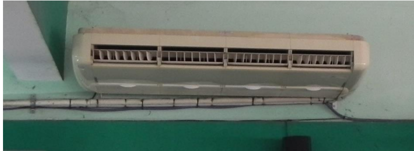
Fotografía 5.1 – Aire acondicionado – Elaboración propia
