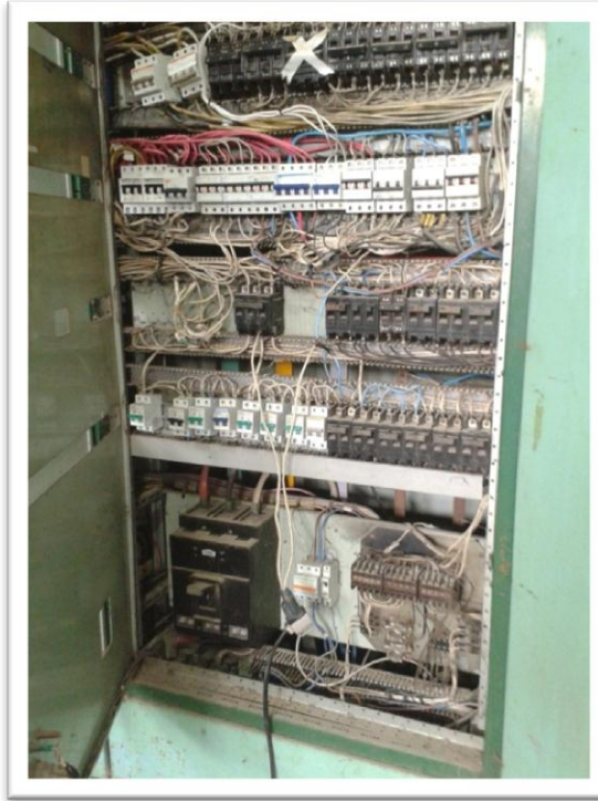
Imagen N°35: Interior del tablero seccional.
