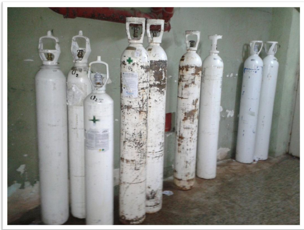
Imagen N°55: Almacenamiento de gases medicinales en sala de máquinas.
