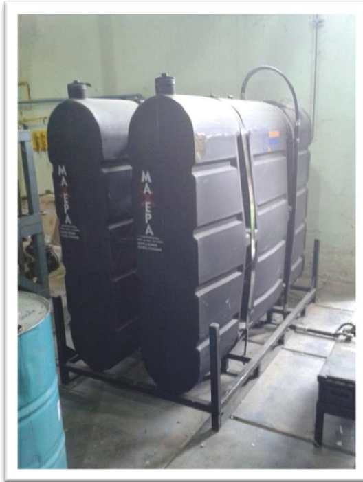
Imagen N°16: Sala de máquinas. Tanques de combustible del generador.
