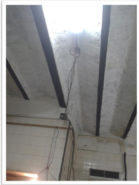
Imagen N°27: Instalación eléctrica aérea en el taller de refrigeración.
