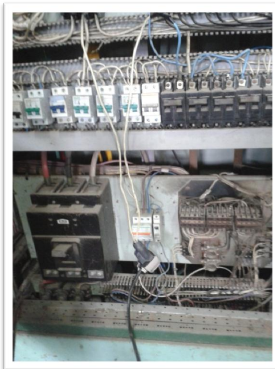
Imagen N°36: Interior del tablero seccional.
