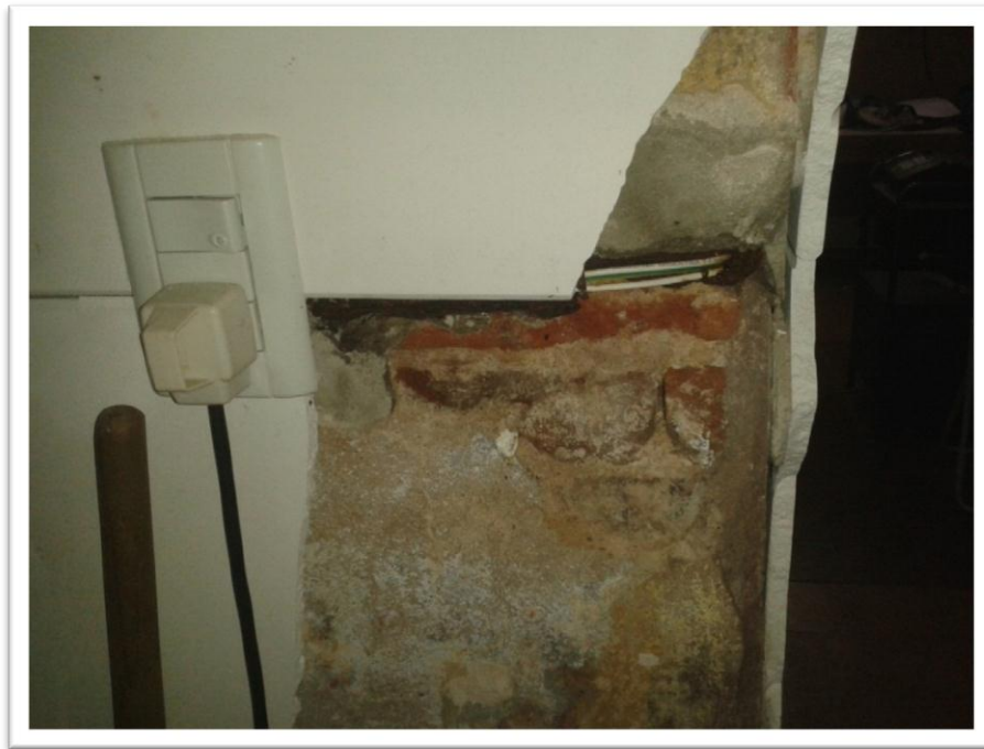
Imagen N°30: Canalización corroída en el taller de electromedicina.
