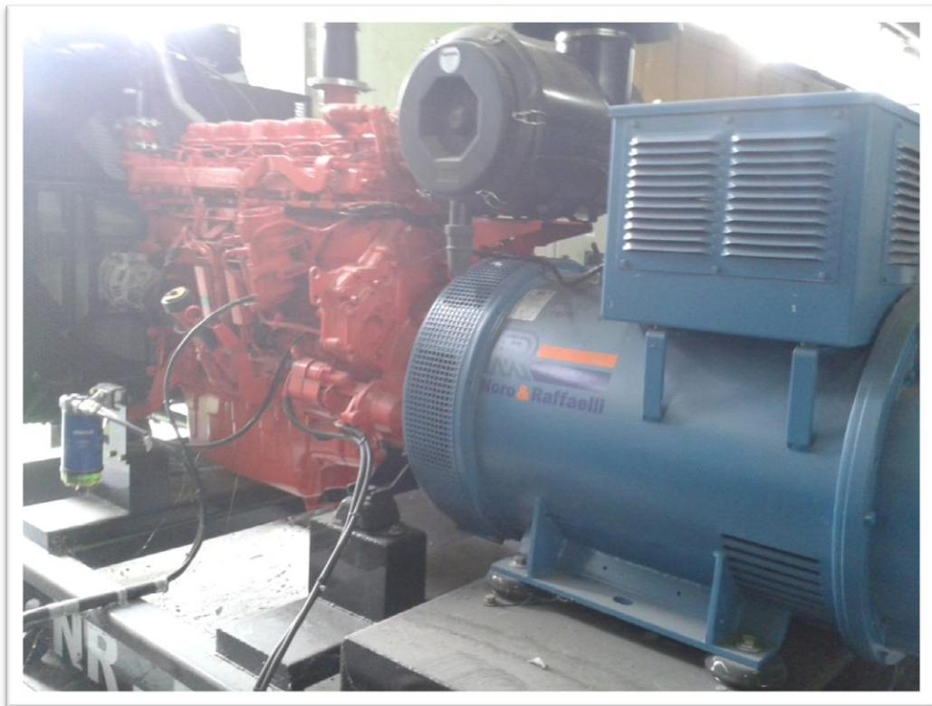
Imagen N°17: Sala de máquinas. Generador eléctrico.
