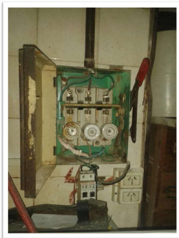
Imagen N°26: Tablero seccional del taller de refrigeración.
