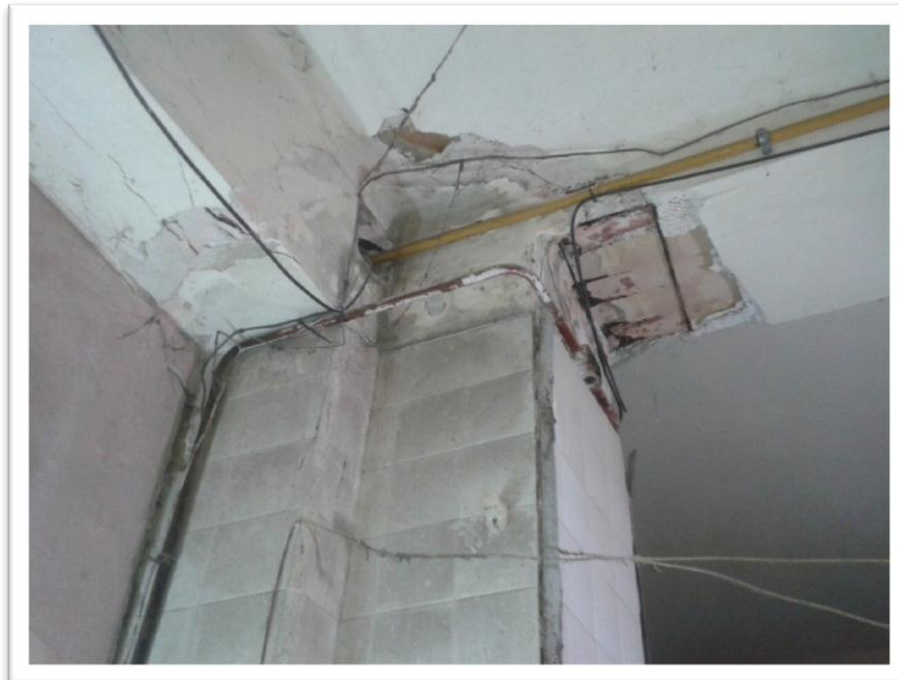
Imagen N°28: Instalación eléctrica aérea en el taller de refrigeración.
