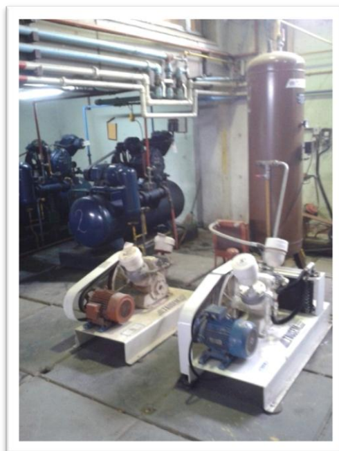
Imagen N°52: Compresores en sala de máquinas.
