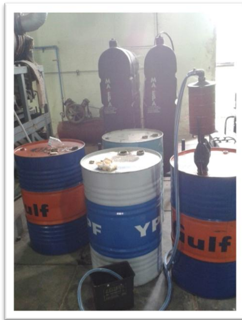
Imagen N°18: Sala de máquinas. Recipientes de lubricante.
