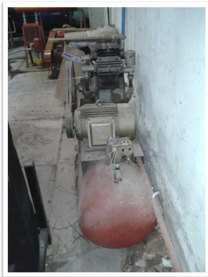
Imagen N°53: Compresores en sala de máquinas.
