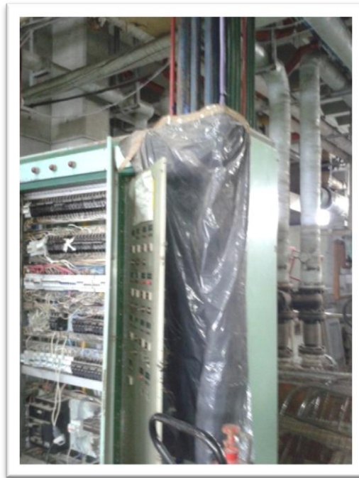
Imagen N°34: Tablero seccional en sala de máquinas.
