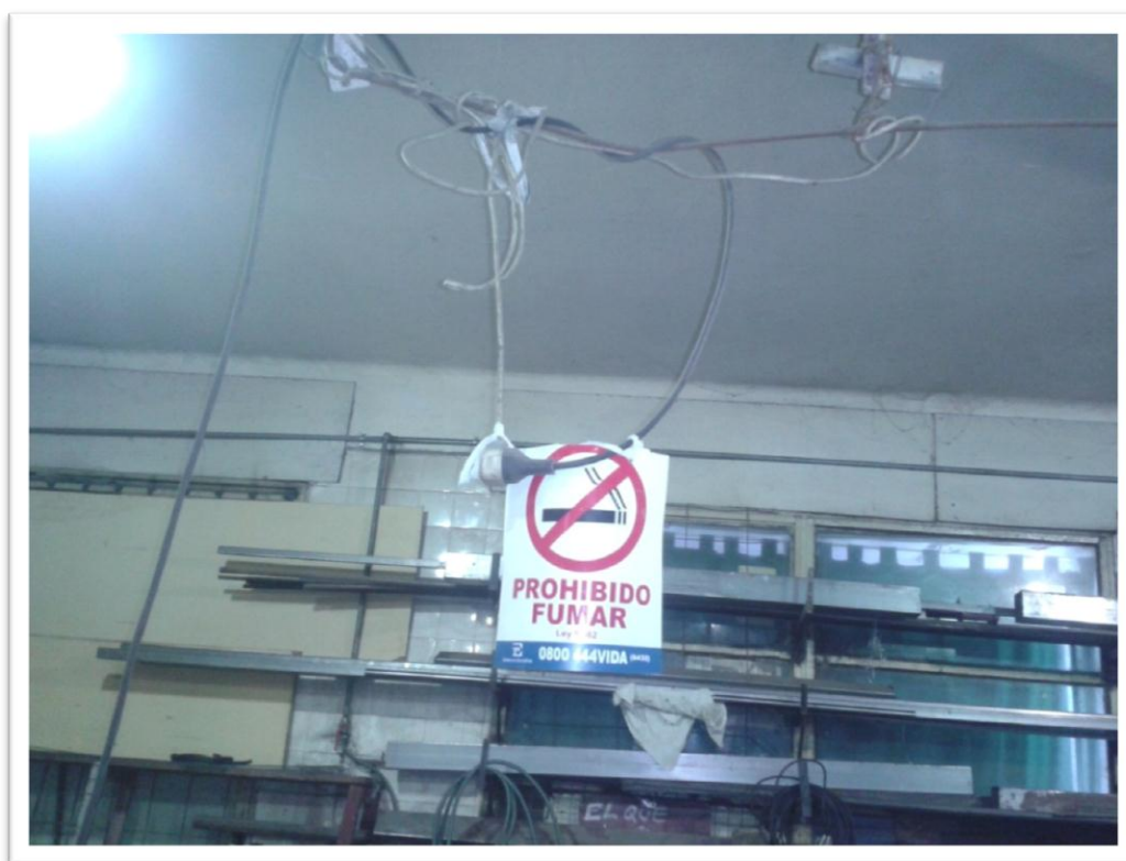
Imagen N°29: Instalación eléctrica aérea en el taller de herrería.
