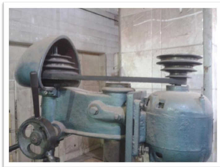
Imagen N°38: Detalle de la falta de protección contra atrapamientos en la perforadora.
