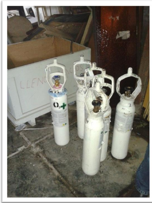
Imagen N°54: Almacenamiento de gases medicinales en sala de máquinas.
