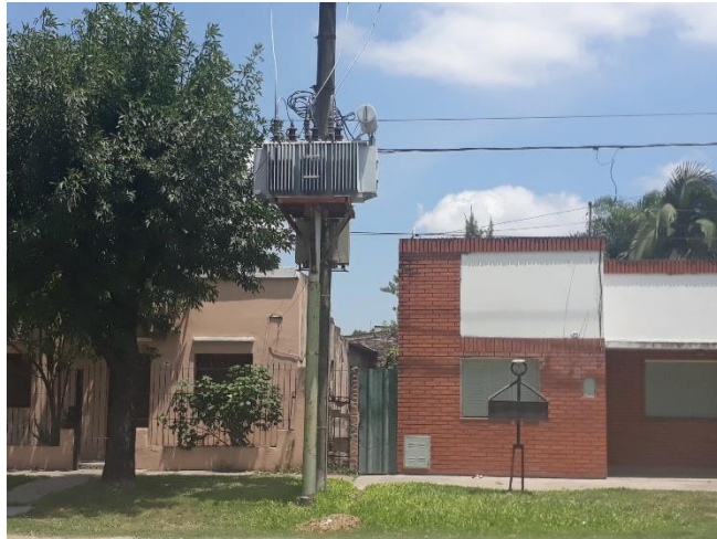
Figura 3.1 – Puesto de transformación N° 1
