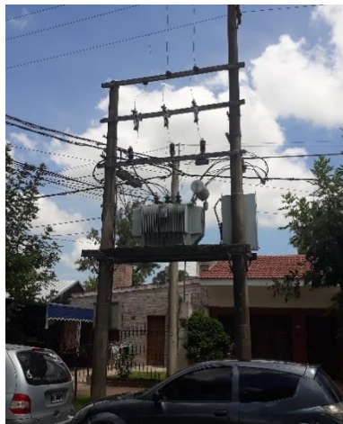
Figura 8.1 – Puesto de transformación N° 6
