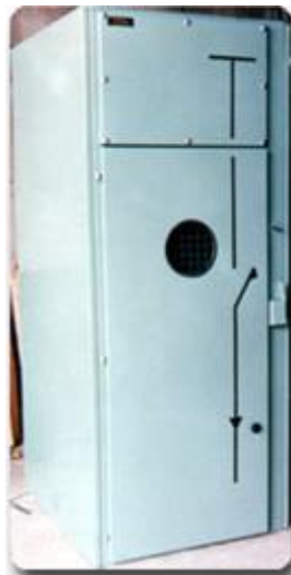
Figura 1.4- Celdas de 13,2 kV
