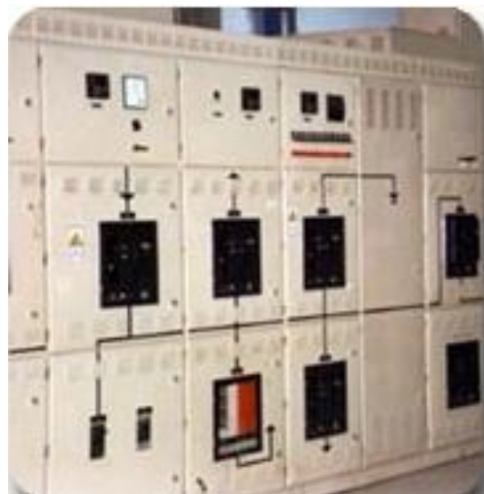
Figura 1.6- Tableros de medición y control
