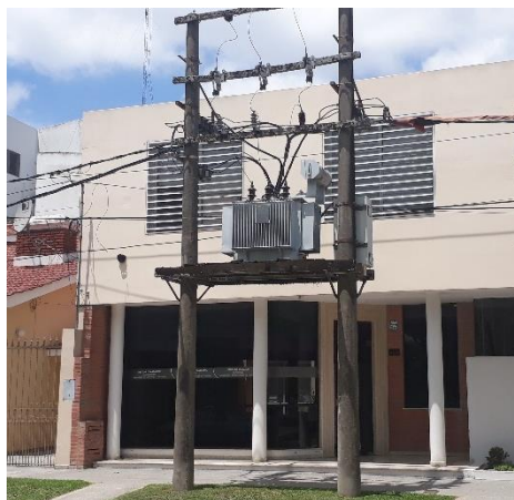
Figura 6.1 – Puesto de transformación N° 4
