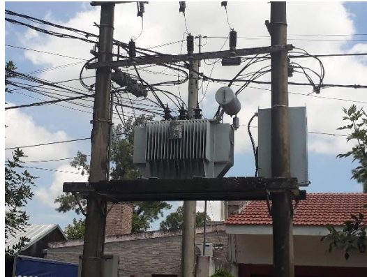
Figura 1.7 – Puesto aéreo de transformación biposte
