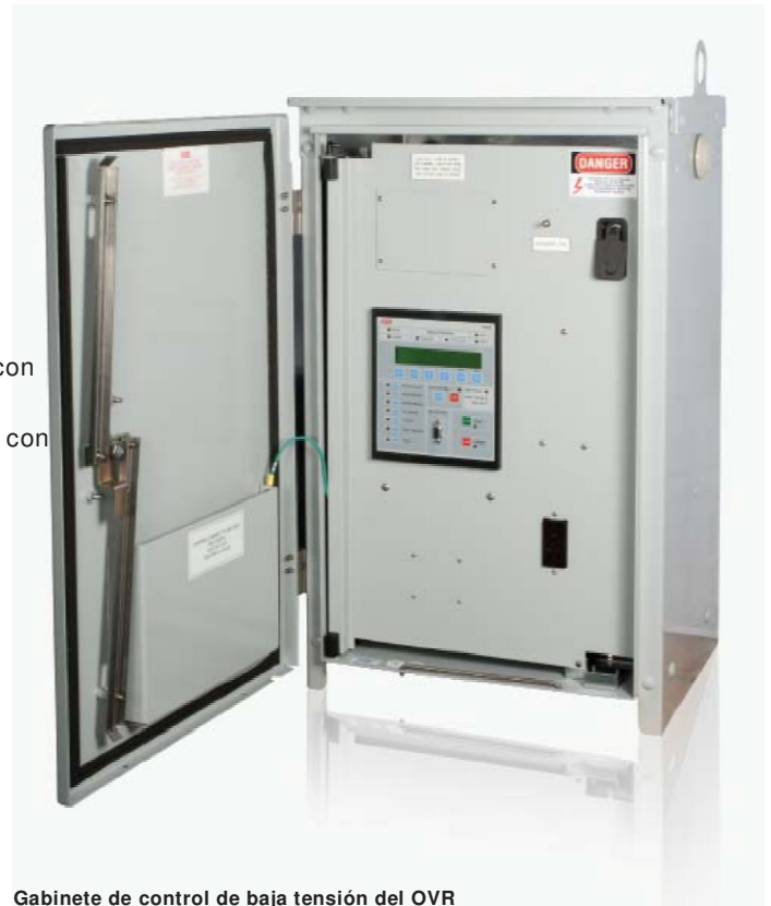
Gabinete de control de baja tensión del OVR
