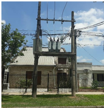
Figura 4.1 – Puesto de transformación N ° 2
