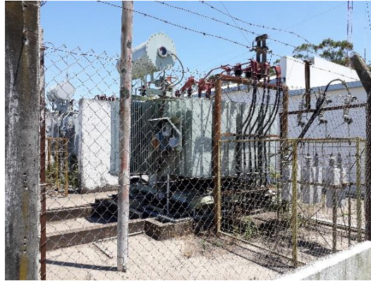
Figura 1.3 – Transformador de potencia
