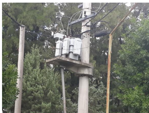
Figura 1.6 – Puesto aéreo de transformación monoposte
