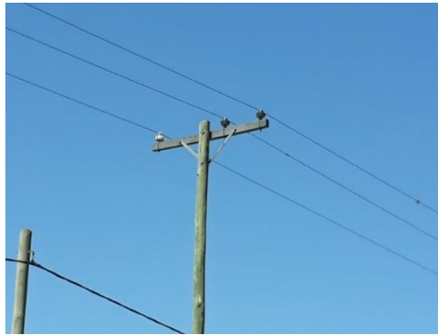
Figura 1.10- Línea rural trifásica 13,2 kV
