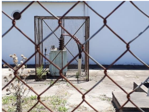
Figura 1.5 – Transformador de servicios auxiliares
