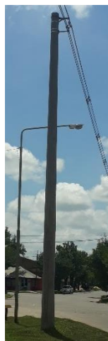
Figura 1.2- Líneas aéreas compactas
