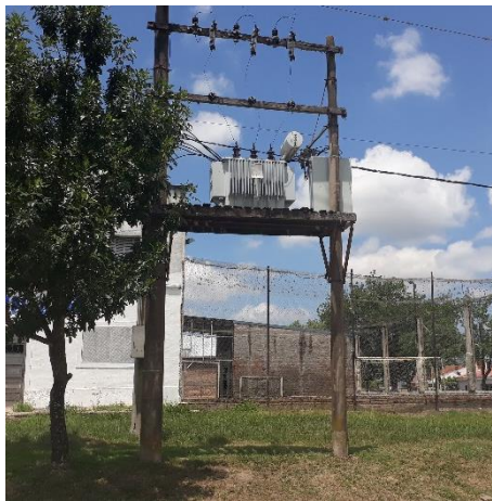
Figura 5.1 – Puesto de transformación N° 3
