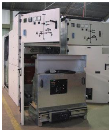
Figura 1.2- Celdas de 33 kV
