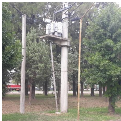
Figura 7.1 – Puesto de transformación N° 5
