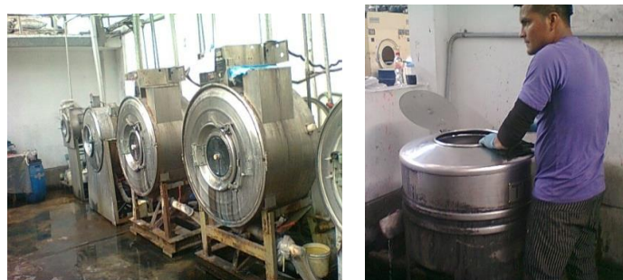
Figura 27 – Equipos de planta máquina de agotamiento a la izquierda y centrifuga a la derecha
