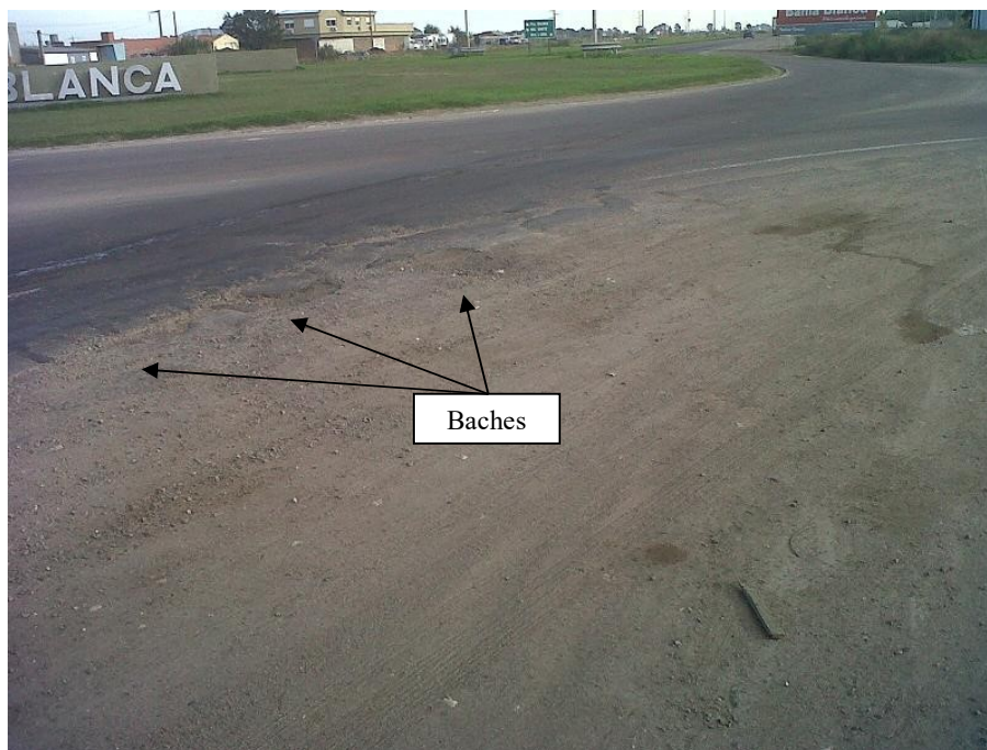
Imagen AI.1: Estado de banquina en condiciones peligrosas (Vulnerabilidad Técnica).
