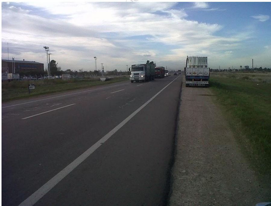
Imagen AI.7: Ausencia de dársena de giro a la izquierda en el acceso a Cooperativa Obrera (Vulnerabilidad Económica).
