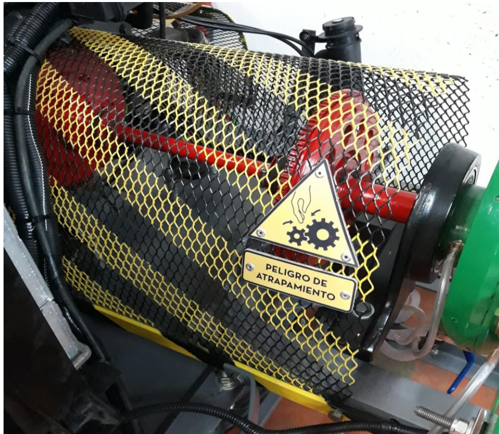
Fig. 5.12: Sistema de transmisión de potencia con su respectiva protección.
