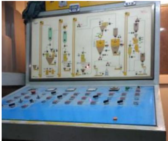
Ilustración 41 - Tablero de comando principal
