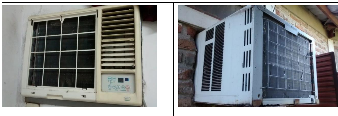
Fotografía 3.10- Aires Acondicionados -Elaboración propia
