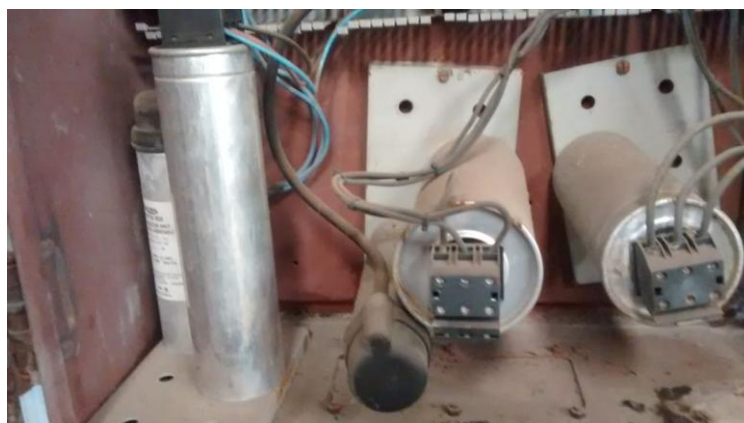
Fotografía 3.1- Banco de capacitores de la empresa -Elaboración propia
