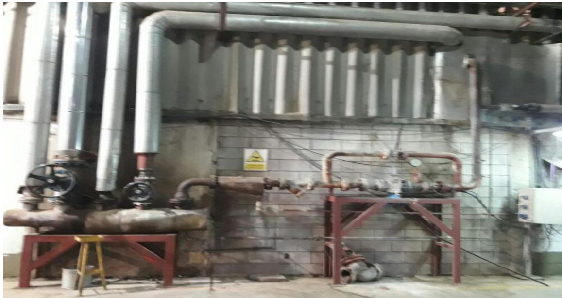
Figura 23. Foto de la instalación original.
