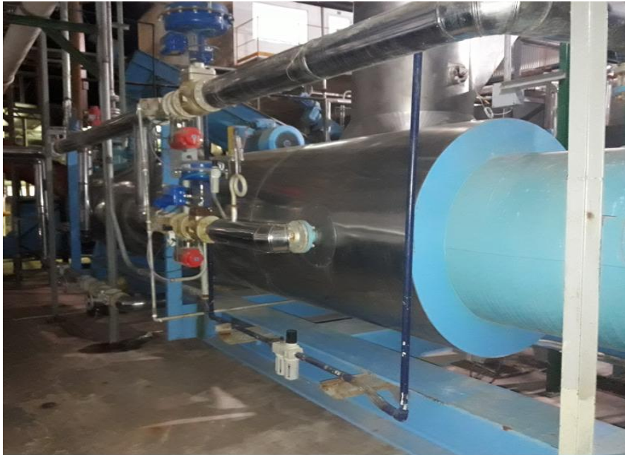
Figura 34. Foto del hidrolizador continuo en planta.
