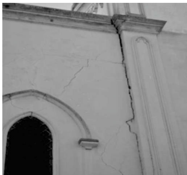
Figura 20. Detalle de la fisura que se desarrolla entre la ampliación y la estructura original.
