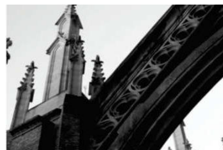
Figura 7. Vista de un arbotante. Se observa el manto biogénico.
