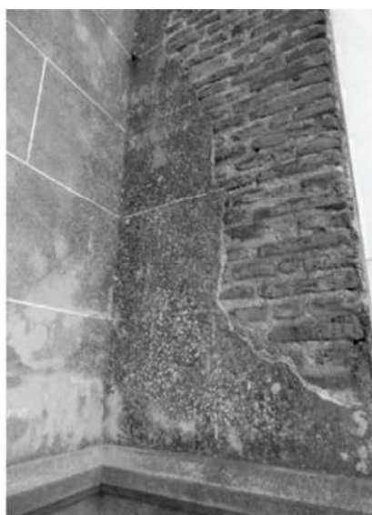
Figura 24. Detalle de desprendimientos de revoques en muros exteriores.
