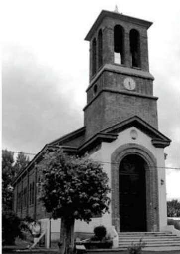
Figura 26. Vista de la iglesia, Bellocq. Se observa la cúpula faltante.
