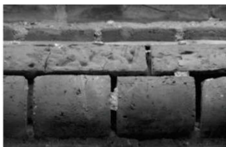
Figura 5. Detalle de la mampostería. Se observan la ausencia de las juntas de asiento.
