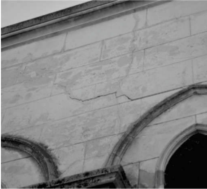
Figura 21. Detalle de la fisura que se desarrolla por movimientos de las estructuras de la ampliación y la original.
