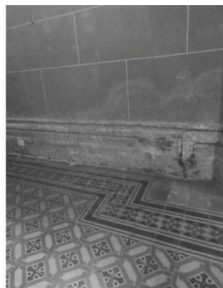
Figura 25. Detalle de muros interiores afectados por ascensión capilar.
