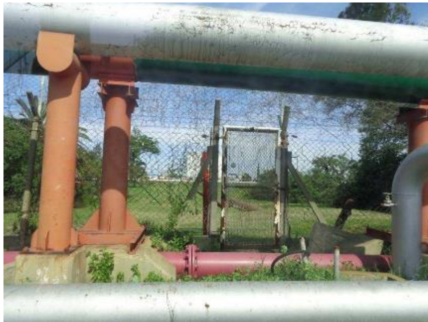
Foto G: Vista hacia el SE. Alambrado de las UNIDADES DE PROCESO, punto de cruce de las instalaciones del Proyecto.
