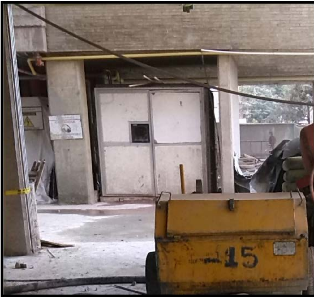
Ilustración 9 Cabina instalada en proyecto, vista 1
