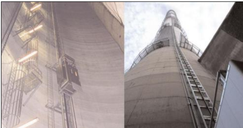
Ilustración 15. Ejemplo de ascensores instalados en torres
