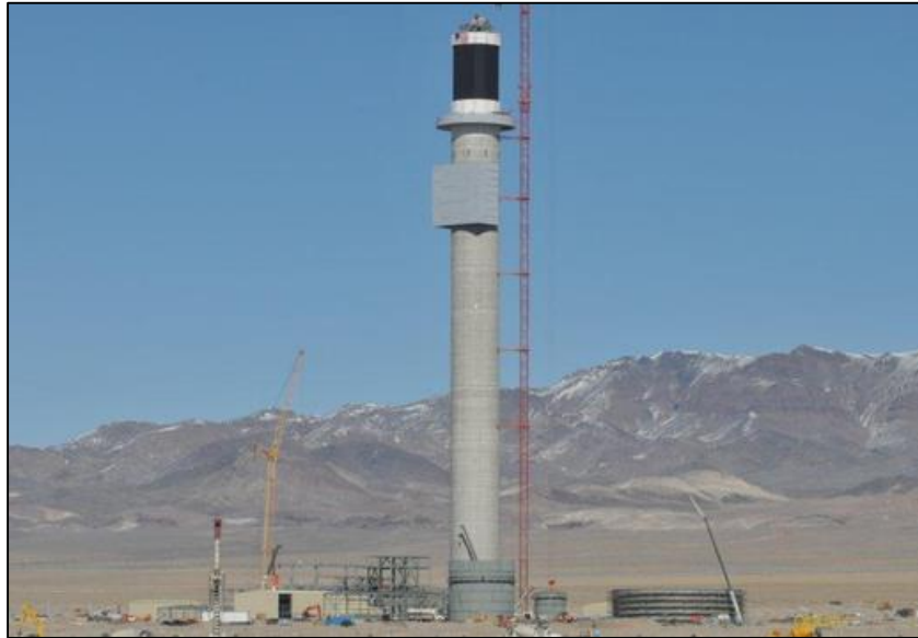
Ilustración 30. Torre con receptor cilíndrico externo
