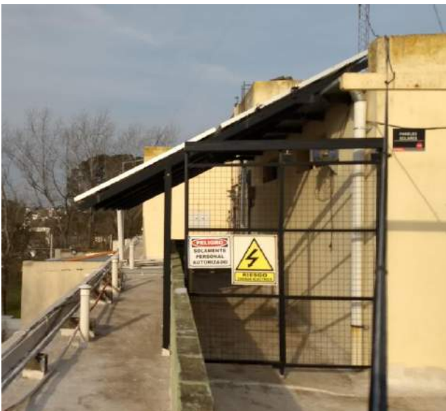
Fig. 3. Vista del ancho de la instalación solar.
