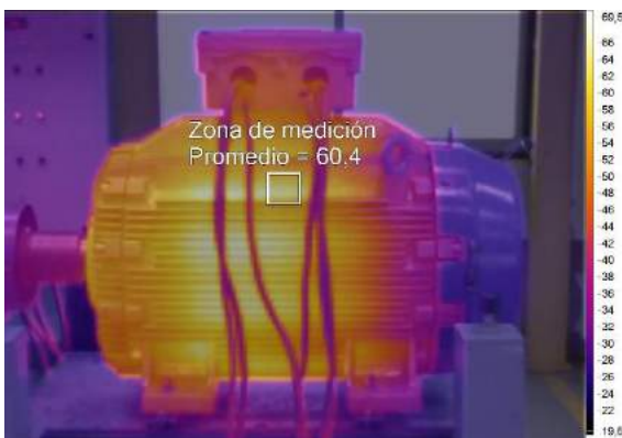
Fig. 2. Imagen termográfica a motor de 260 kW, 4 polos.
