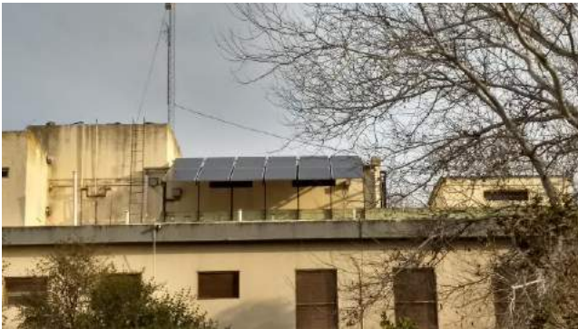
Fig. 2. Instalación solar vista desde el patio interno.
